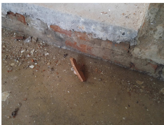
Foto /7/ - Stojící voda – zatékání srážkové vody do suterénu
