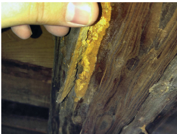
Foto /28/ - Poškozený dřevěný prvek (poškození činností dřevokazného hmyzu)
