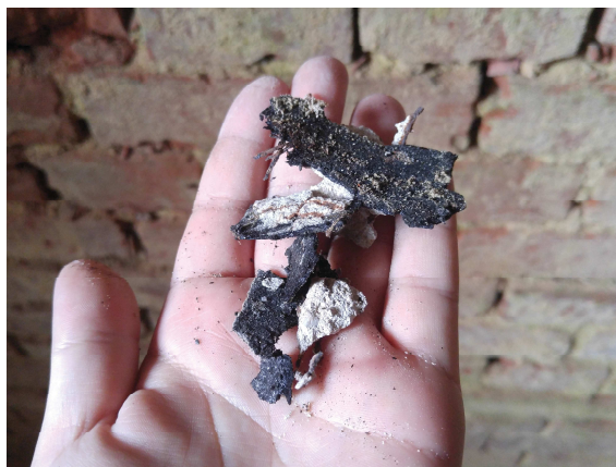
Foto /9/ - asfaltová hydroizolace je již dožilá, křehká
