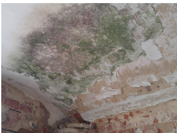
Foto /6/ - Řasy na spodním líci stropní konstrukce suterén
