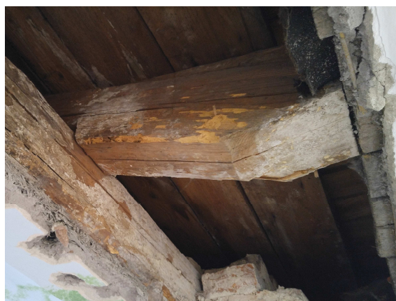
Foto /25/ - Pohled na napadenou krokev (poškození činností dřevokazného hmyzu)
