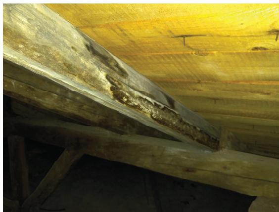
Foto /29/ - Pohled na degradovanou krokve Stopy po zatékání srážkové vody
