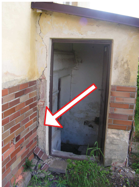
Foto /11/ - Poškozený soklový obklad v místě přístavby v severní části objektu
