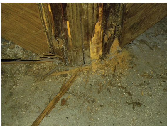
Foto /26/ - Pohled na degradovaný sloupek (poškození činností dřevokazného hmyzu)
