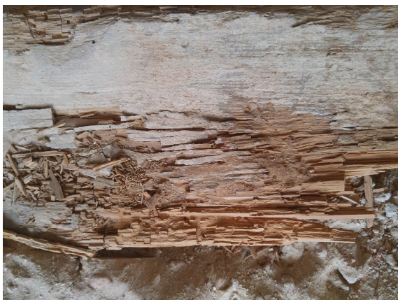
Foto /32/ - Degradovaný stropní trám (napadení dřevokazným hmyzem)
