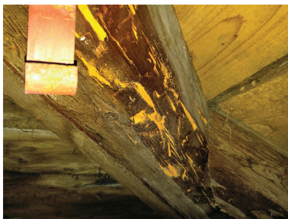
Foto /27/ - Pohled na degradovaný prvek (poškození činností dřevokazného hmyzu)
