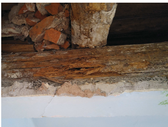
Foto /24/ - Pohled na napadenou krokev (poškození činností dřevokazného hmyzu)
