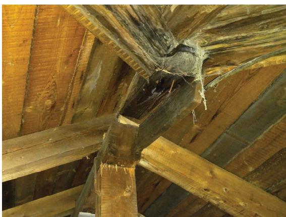
Foto /30/ - Pohled do konstrukce krovu Stopy po zatékání srážkové vody
