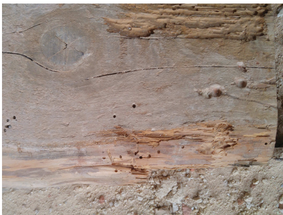
Foto /33/ - Degradovaný stropní trám (napadení dřevokazným hmyzem)
