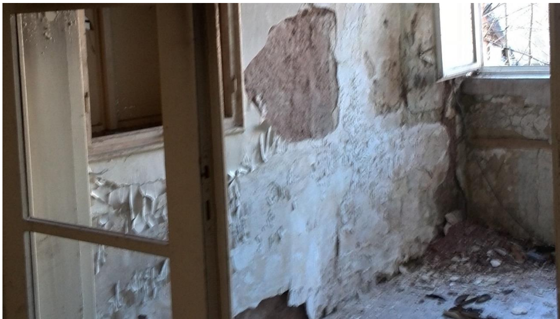
Obrázek 16 – Zatékání do objektu trvale otevřeným oknem
