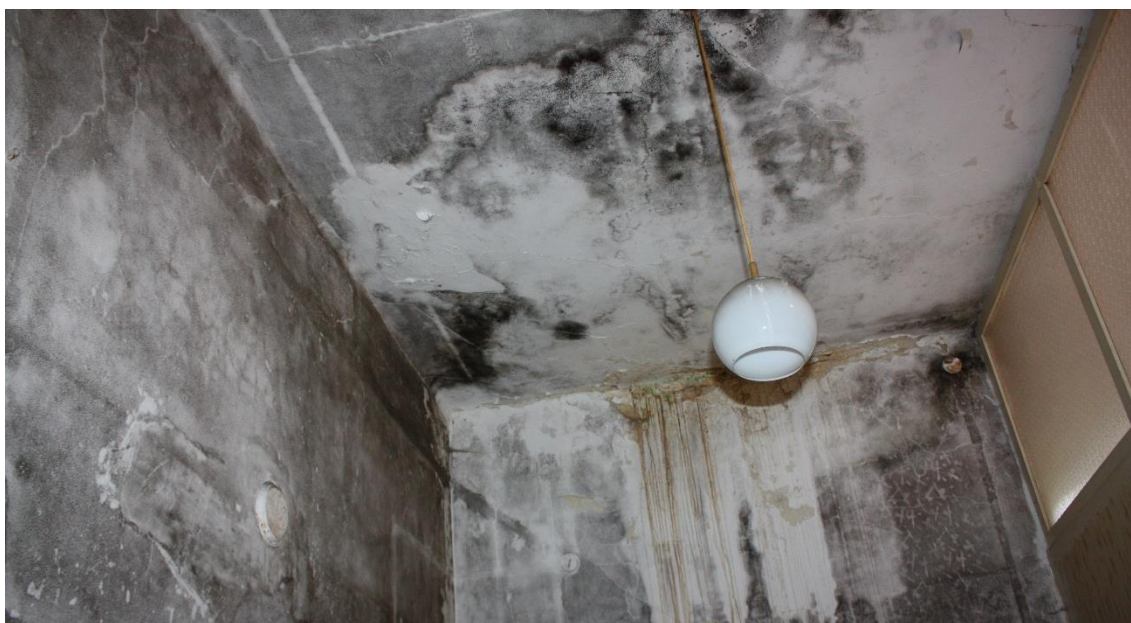
Obrázek 17 – Plísně na zdivu v kuchyni 2. NP
