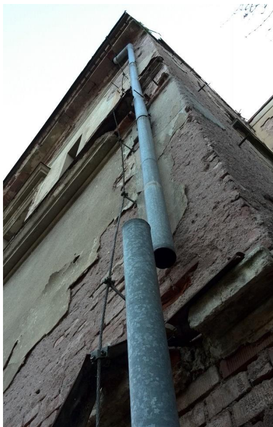
Obrázek 12 – Degradovaná korunní římsa a přerušný svod
