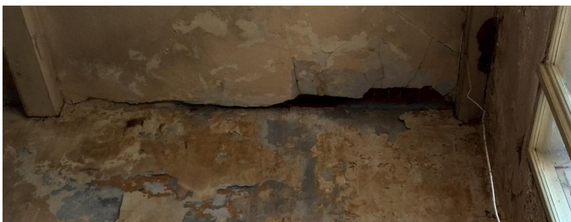
Obrázek 7 – Poškození stropní konstrukce nad schodištěm
