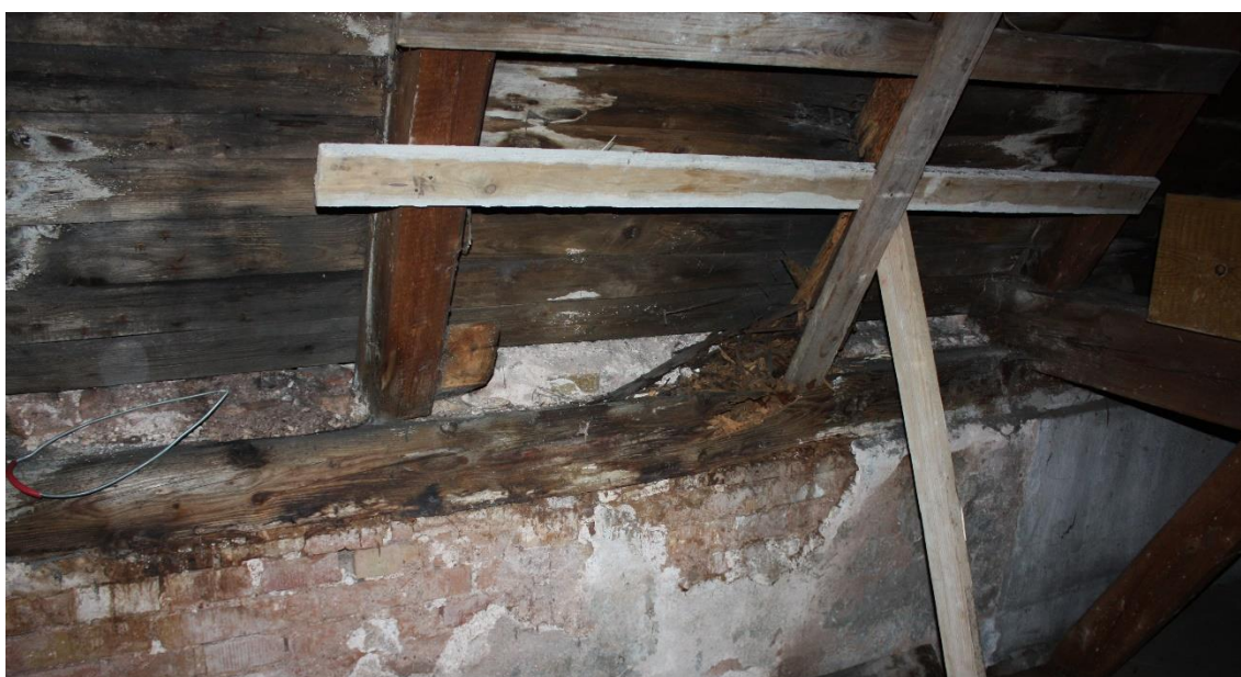
Obrázek 10 – Provizorní podepření krokve a rozpad pozednice
