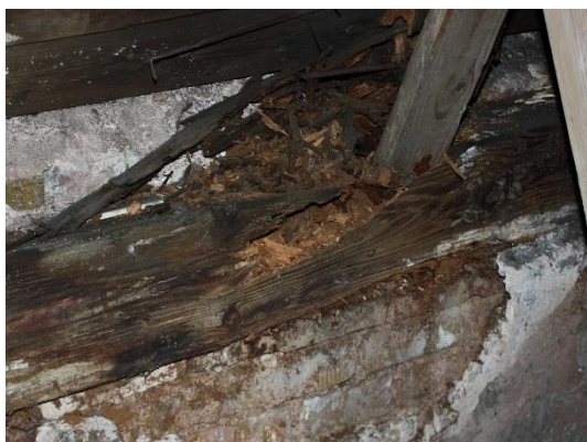
Obrázek 43 – Rozpadající se pozednice
