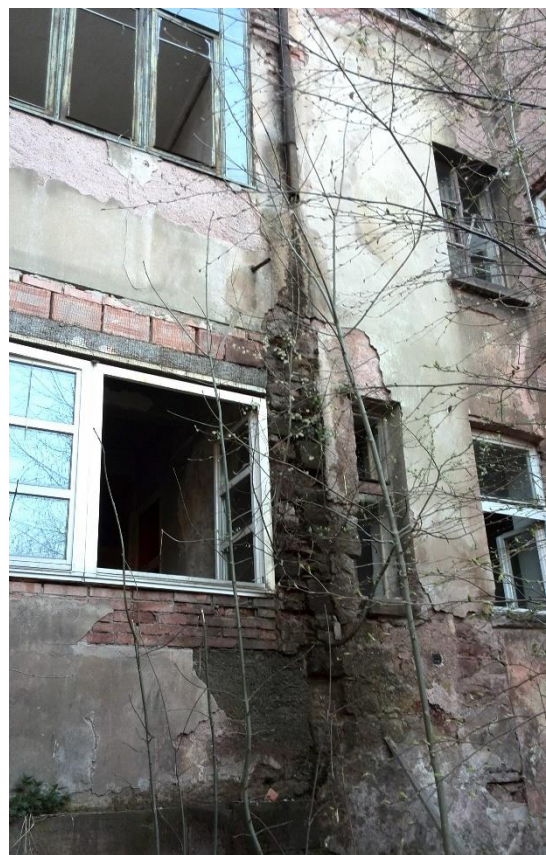
Obrázek 13 – Zatékání do objektu z přerušného svodu
