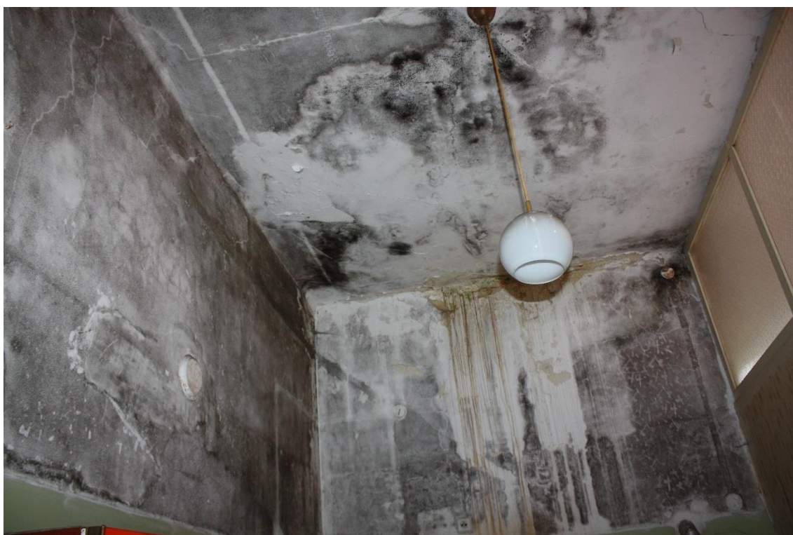
Obrázek 37 – Zdi kuchyně napadené plísní
