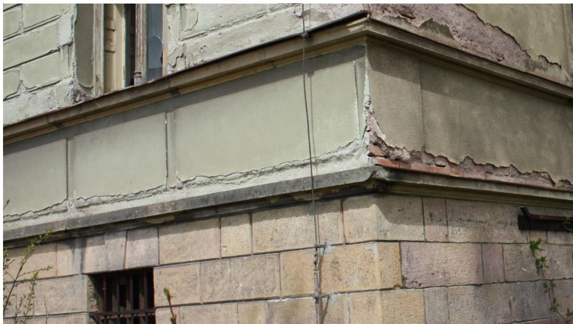
Obrázek 14 – Opadávající omítka nad špatně spádovanou římsou
