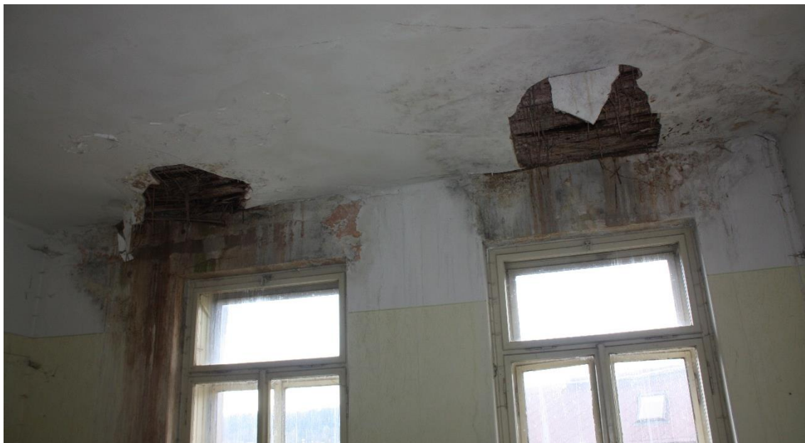
Obrázek 25 – Propadlý strop v 2. NP
