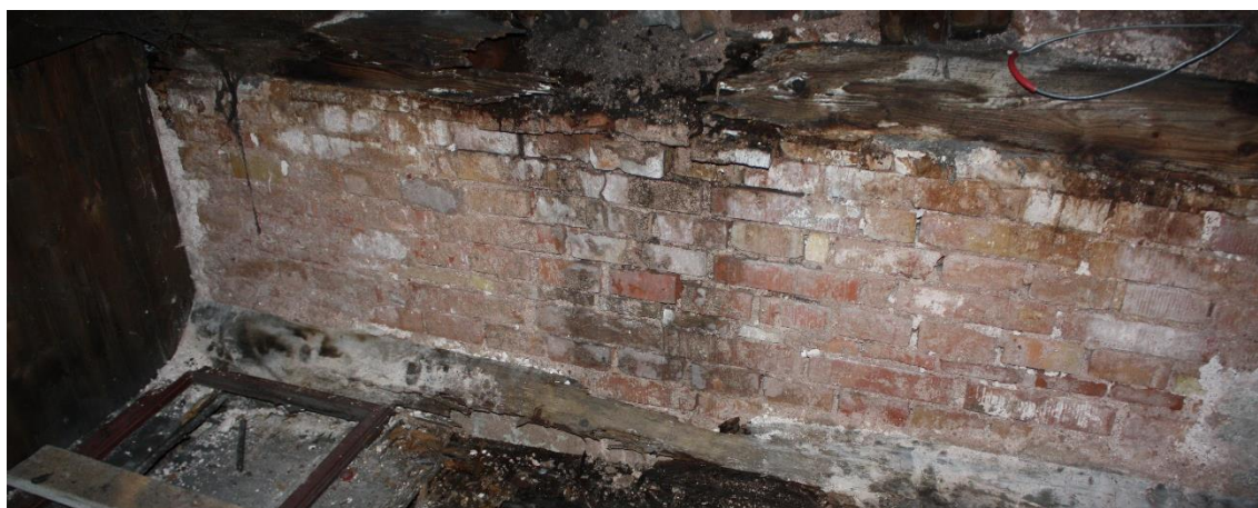
Obrázek 15 – Podezdívka poškozená vlivem zatékání
