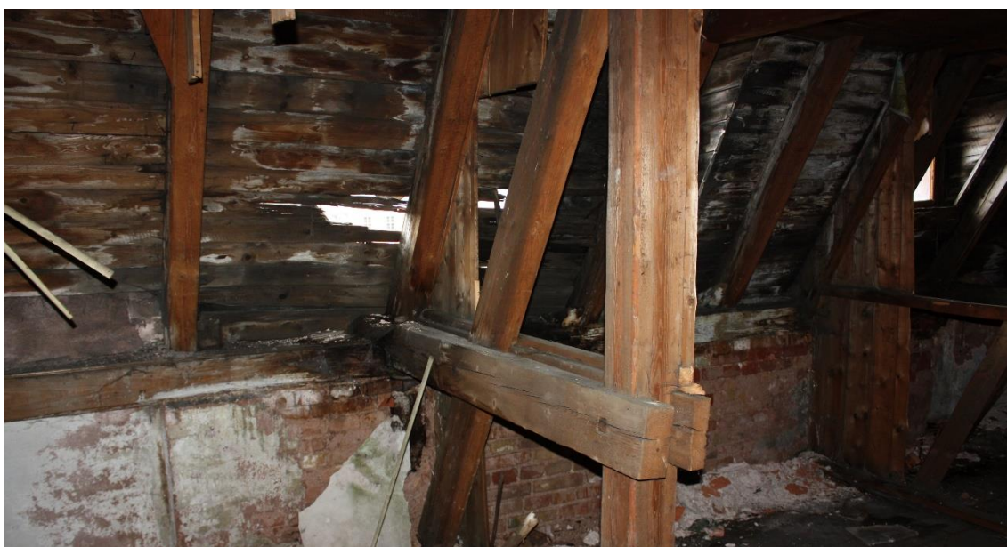
Obrázek 9 – Poškozené pobití v okolí vikýře
