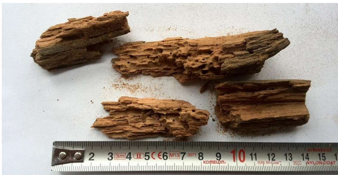
Obrázek 35 – Část podlahy napadená tesaříkem
