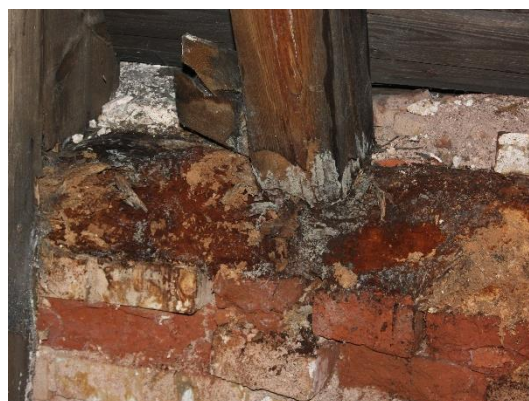
Obrázek 44 – Degradující pozednice a krokev
