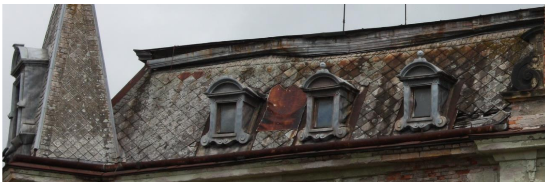
Obrázek 6 – Pohled na poškozenou střešní krytinu
