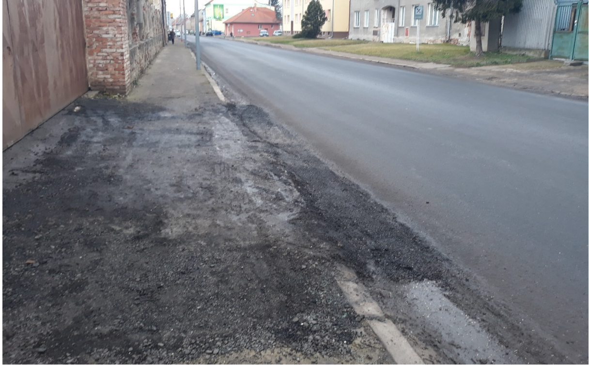
Obr. 30 Znečištění odvodňovací proužek
