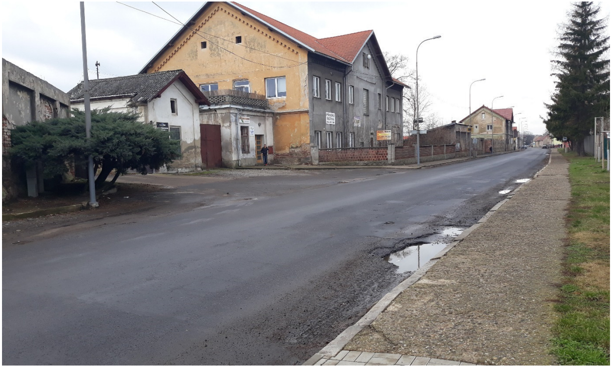
Obr. 33 Stojící voda v porušeném odvodňovacím proužku
