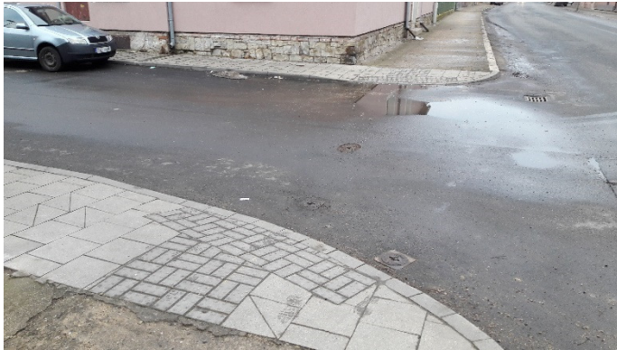
Obr. 9 Nevyhovující místo pro přecházení
