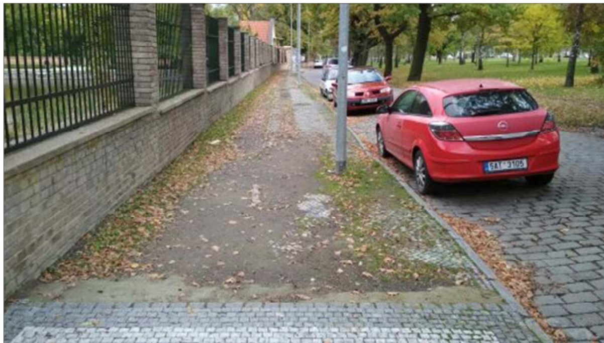
Obr. 1: Zaslepený úsek Radimovy ulice, stávající chodník je v dezolátním stavu.
