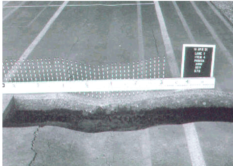
Obrázek 1: Trvalé deformace ve všech vrstvách konstrukce vozovky [5]
