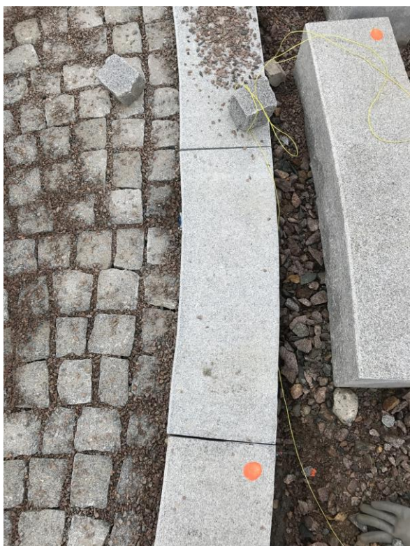
Obrázek 25: Nekvalitní pokládka obrub, zdroj: vlastní fotodokumentace
