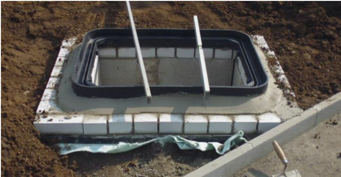
Obrázek 22: Nesoulad s PD ohledně provedení ochrany vstupů do šachty
