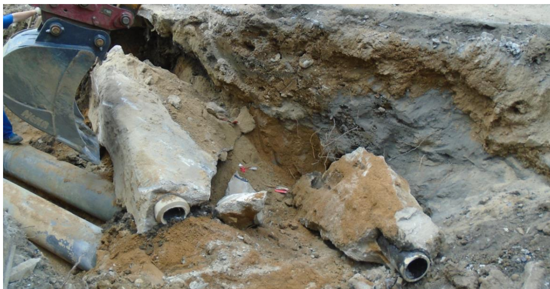
Obrázek 17: Poničené kanalizační potrubí
