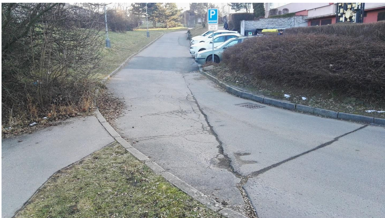
Obrázek 15: Vedení horkovodního potrubí pod komunikací
