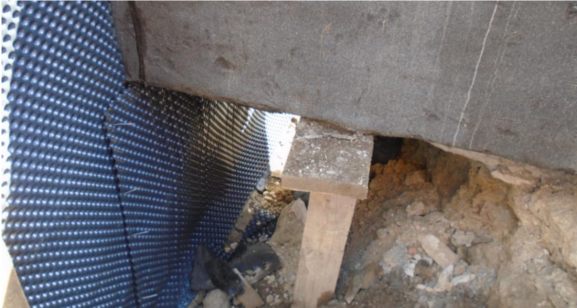
Obrázek 20: Nevhodné podepření stávajícího kanálu Zdroj: vlastní tvorba.
