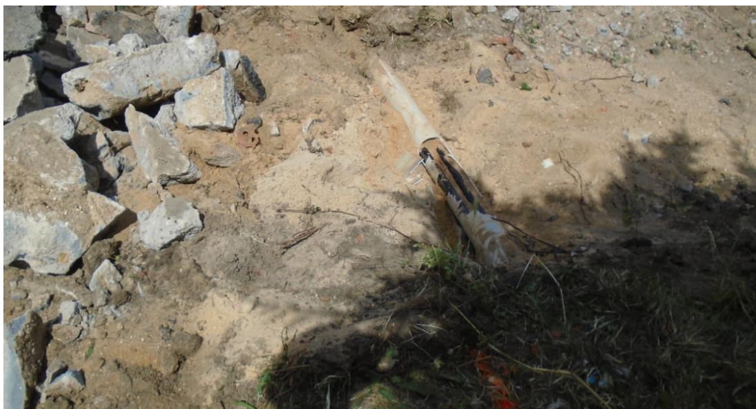
Obrázek 16: Poničená chránička silového vedení
