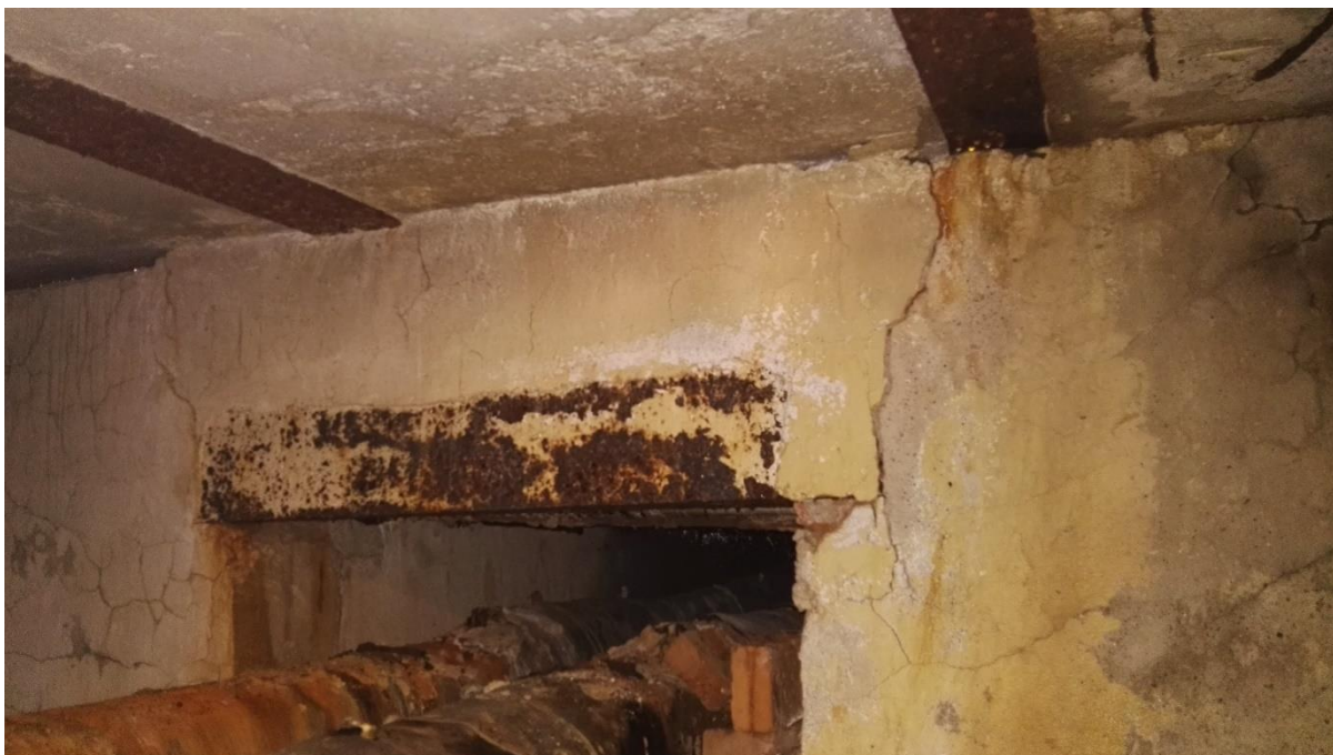
Obrázek 12: Degradace nosných konstrukcí
