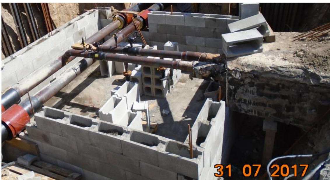
Obrázek 19: Nevhodné podepření stávajícího kanálu
