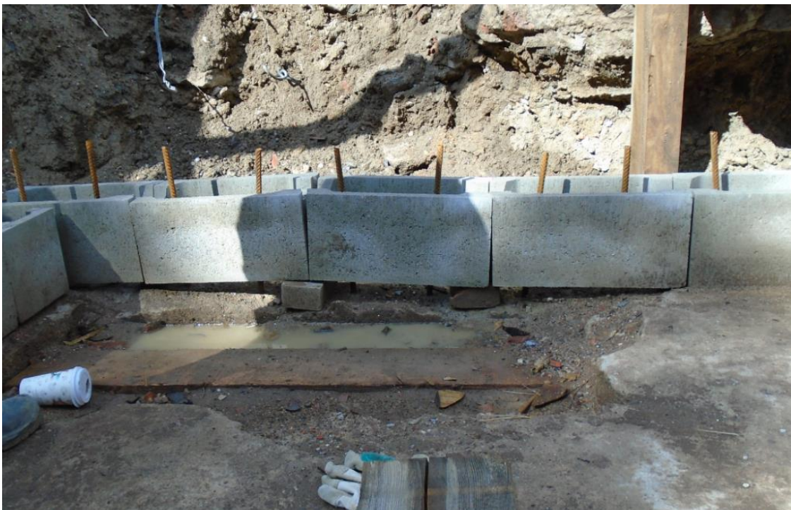
Obrázek 21: Nesprávné založení zdiva šachty BRA09ZEP Zdroj: vlastní tvorba.
