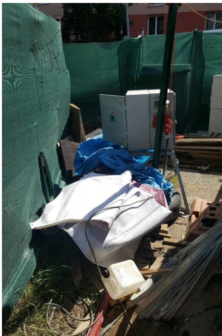
Obr. 4 Nepřístupný hlavní rozvaděč
