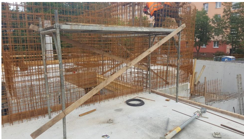
Obr. 36 Nebezpečná pracovní lávka
