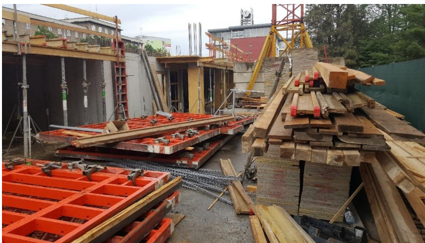
Obr. 27 Nedostatečné hrazení (III)
