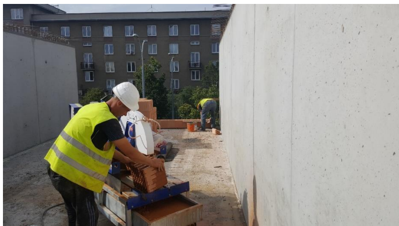
Obr. 15 Nebezpečí pádu z výšky - zdicí práce
