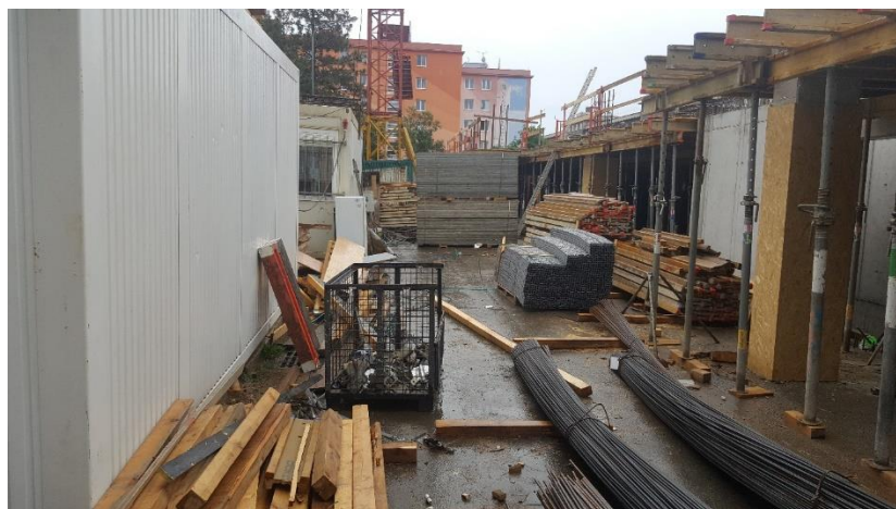
Obr. 39 Nepořádek na staveništi (II)
