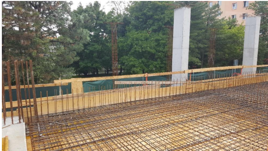
Obr. 29 Nedostatečná výška zábradlí
