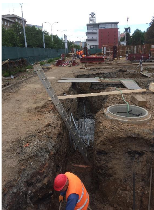
Obr. 10 Neprovedení pažení výkopu (I)
