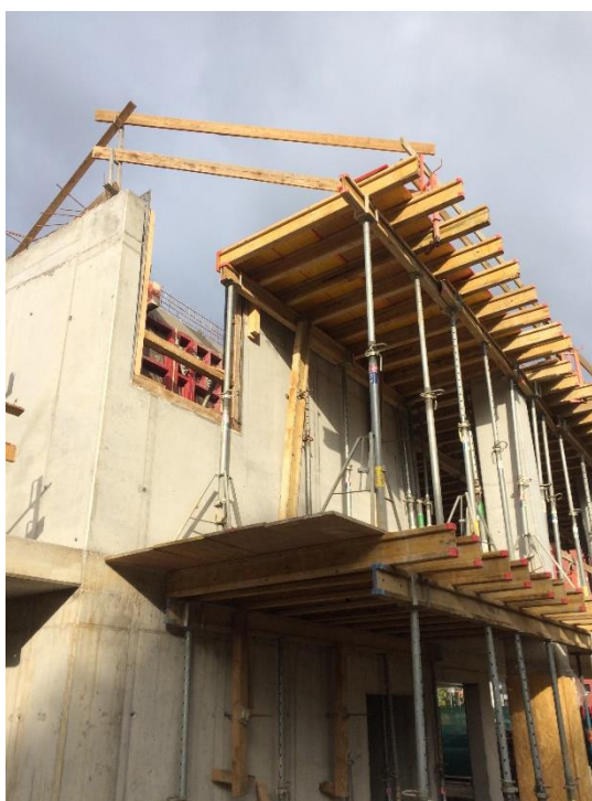
Obr. 28 Zábradlí neslouží svému účelu
