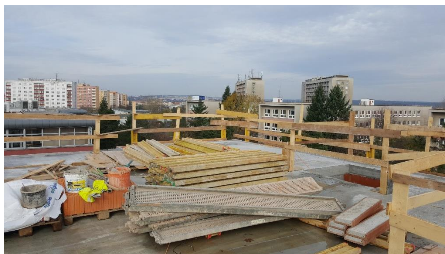
Obr. 24 Nedostatečné hrazení (I)
