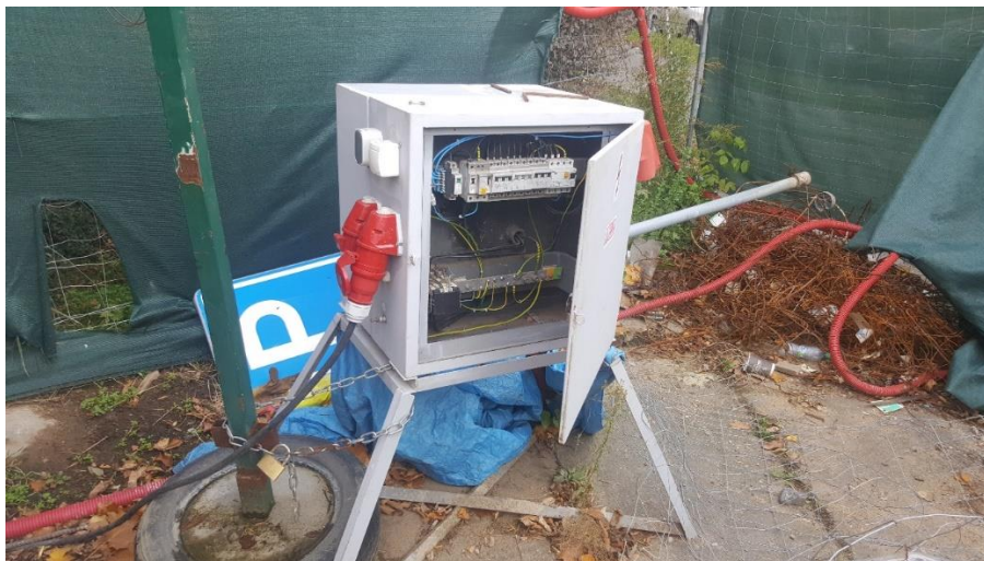
Obr. 5 Nezajištěný hlavní rozvaděč
