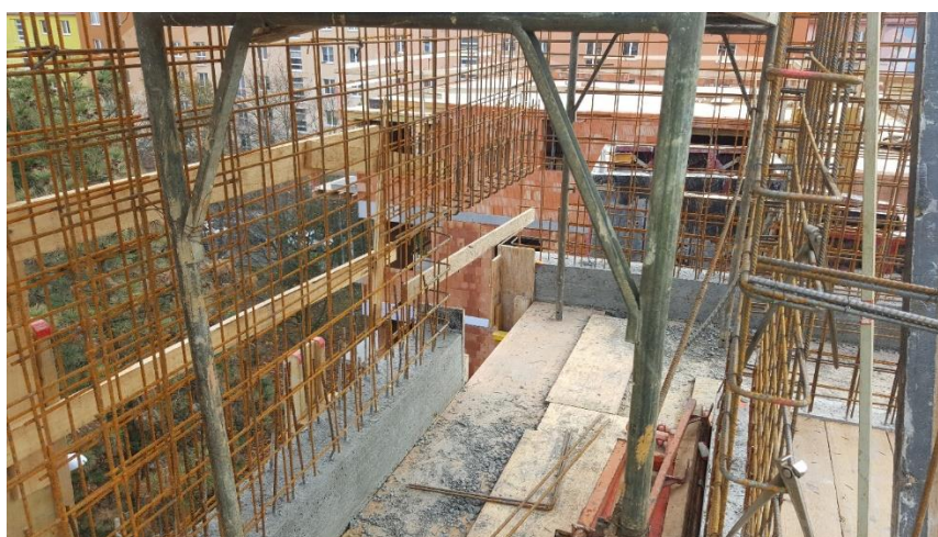
Obr. 32 Nezajištění otvoru (II)
