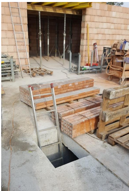
Obr. 33 Nezajištění otvoru - okolo žebříku
