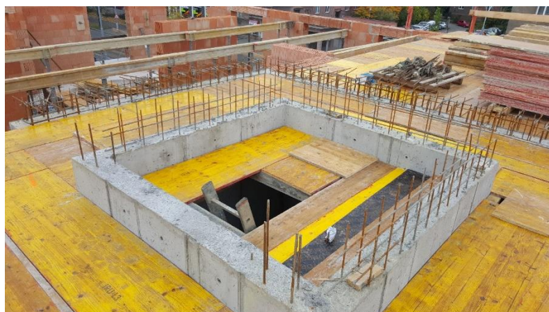
Obr. 12 Nedostatečný přesah žebříku
