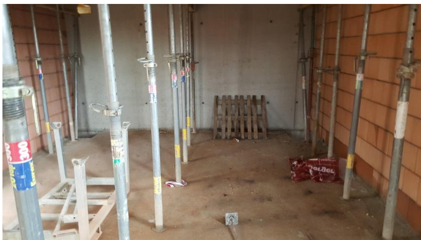
Obr. 31 Nezajištění otvoru - šachty
