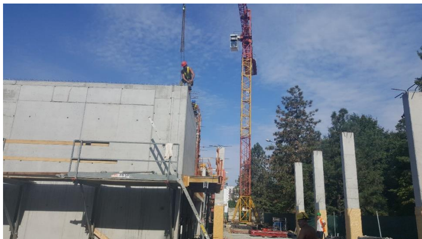
Obr. 13 Nebezpečí pádu z výšky - odbedňovací práce
