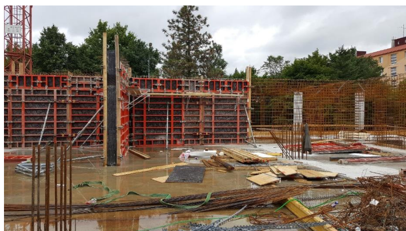
Obr. 38 Nepořádek na staveništi (I)
