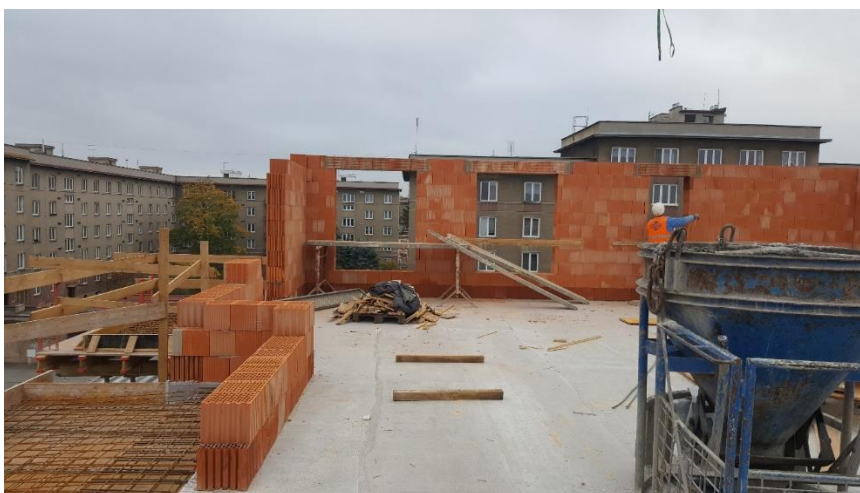
Obr. 34 Vznikající otvory bez zajištění
