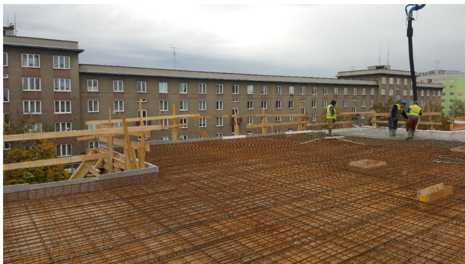
Obr. 25 Nedostatečné hrazení (II)
