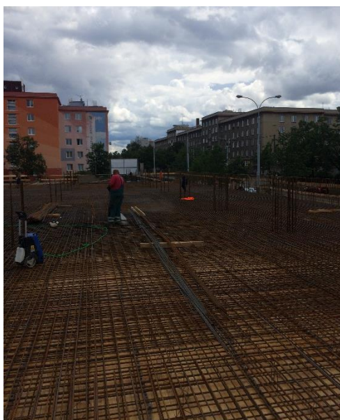
Obr. 8 Nedodržování používání OOPP (II)
