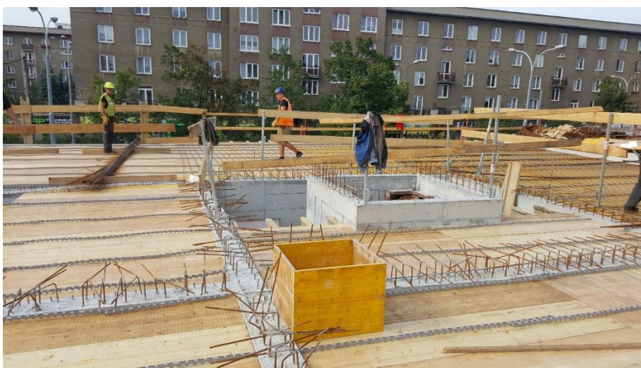
Obr. 26 Neúplné zábradlí kolem šachty
