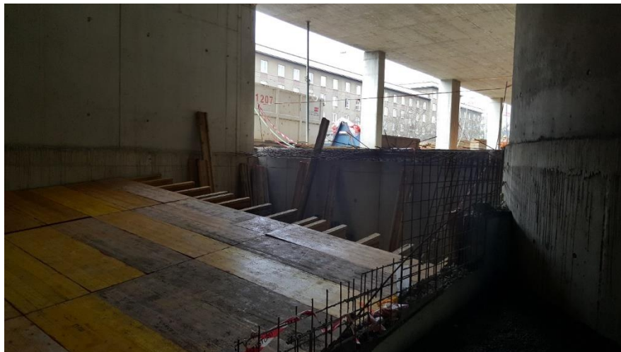
Obr. 30 Nezajištění otvoru (I)
