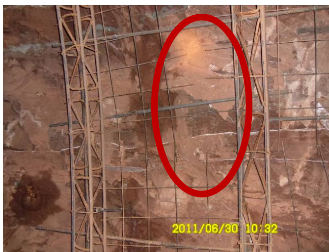
Obr. 14– Nedodržení přesahu kari sítí; zdroj: vlastní
