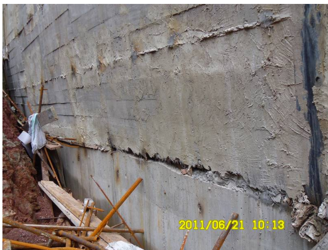
Obr. 19 – Vady na konstrukci hloubeného tunelu; zdroj: vlastní
