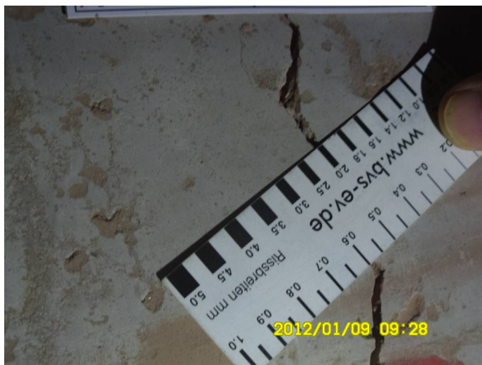
Obr. 17 – Trhliny v definitivním ostění; zdroj: vlastní
