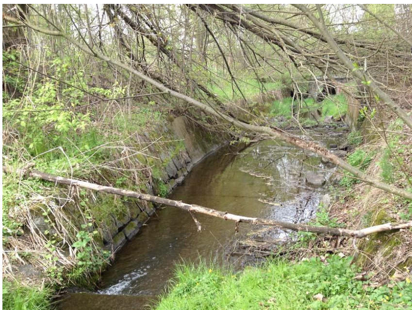
Obrázek č. 39 – Kamenná zděná stěna (po vodě)
