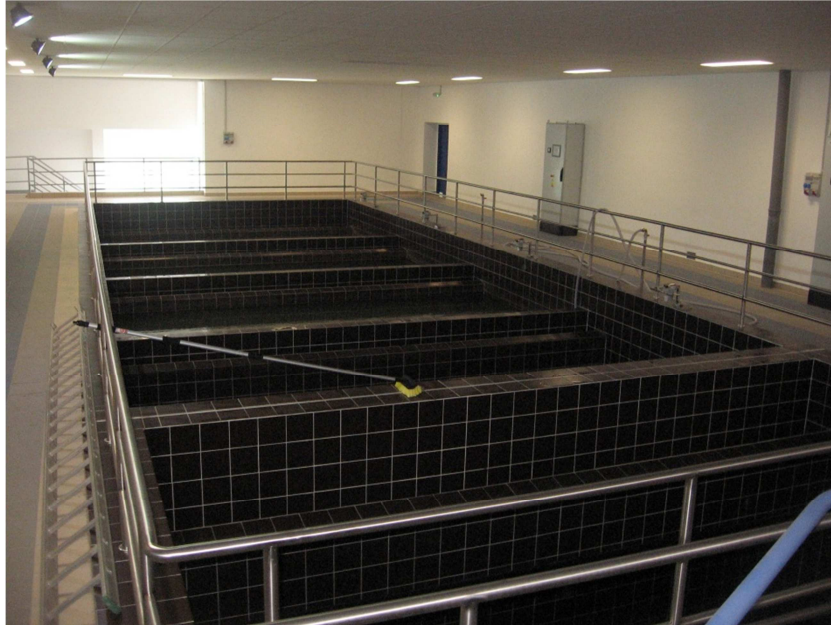
Obrázek 18: Pohled na otevřené rychlofiltry
