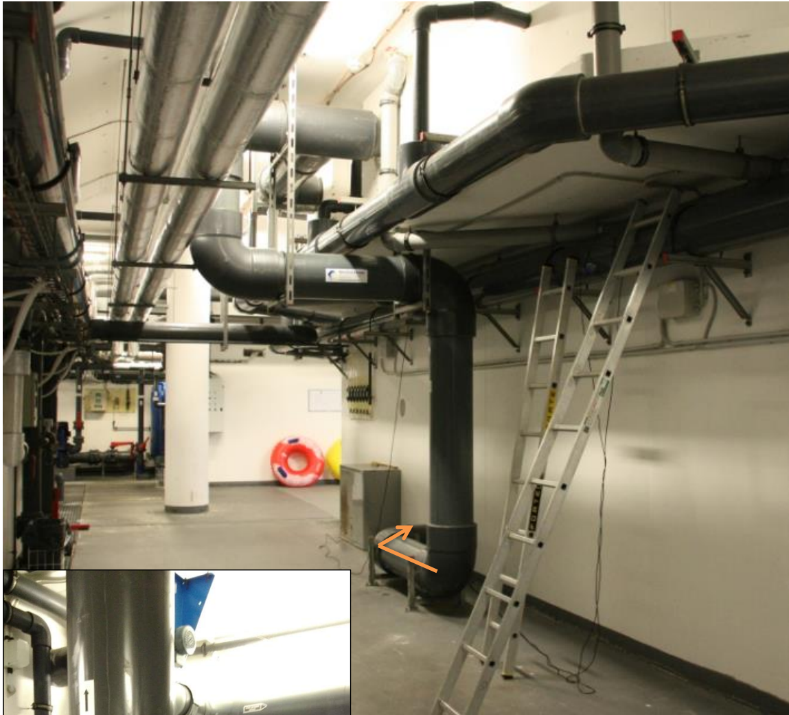
Obr. 3 Pohled na sací potrubí divoké řeky [zdroj: vlastní]
