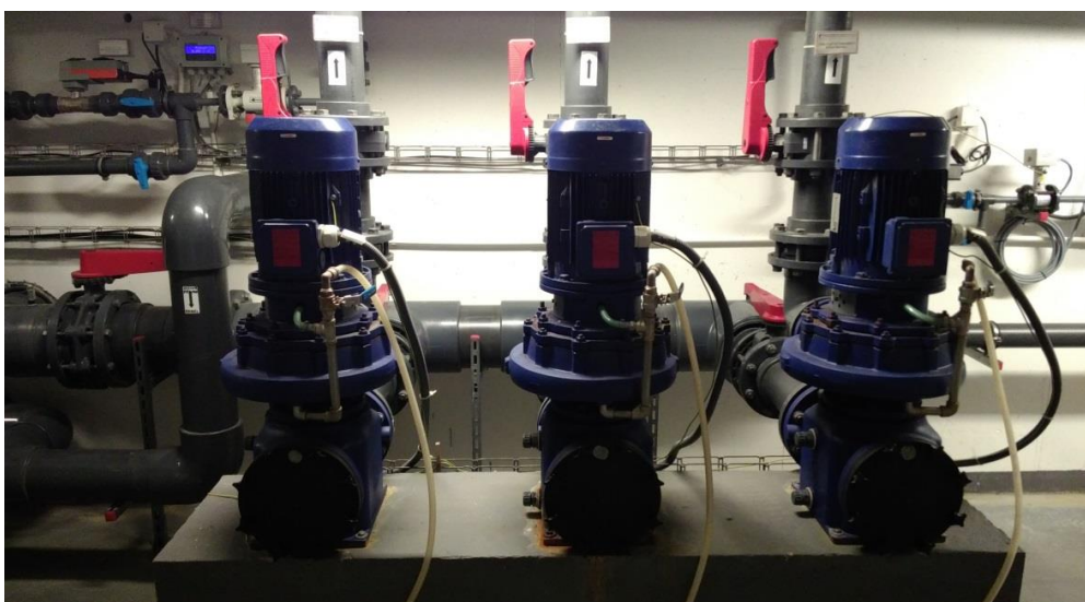
Obr. 2 Pohled na recirkulační čerpadla dvojvířivky [zdroj: vlastní]
