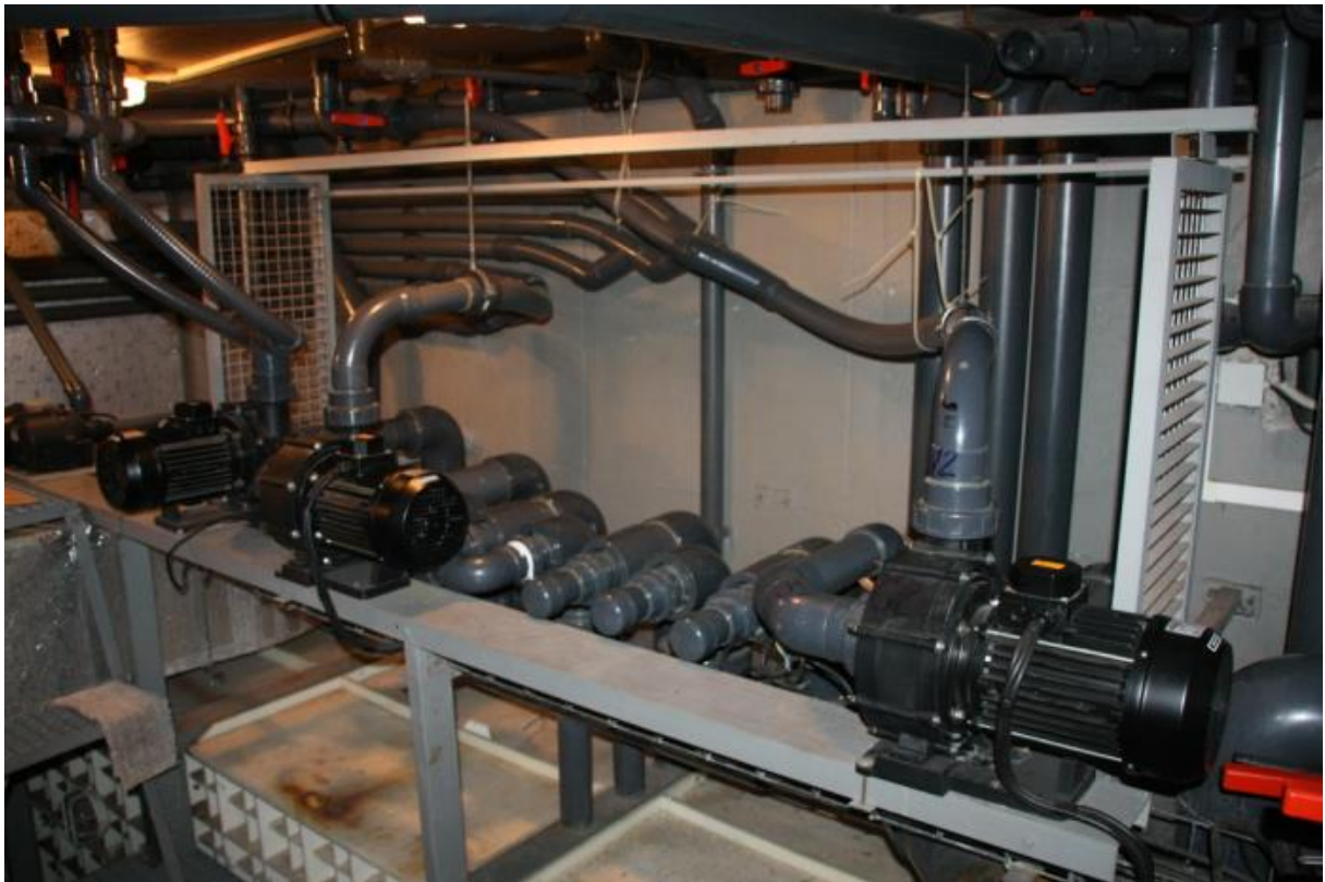
Obr. 1 Pohled na čerpadla bazénu pro potápění [zdroj: vlastní]
