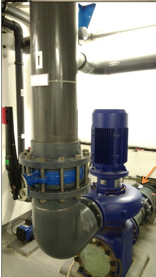
Obr. 2 Pohled na výtlačné potrubí a čerpadlo divoké řeky [zdroj: vlastní]
