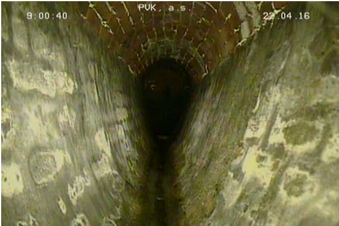
Obr. 11.7: Úsek 1 s patrnou původní sanací ostěni [32]
