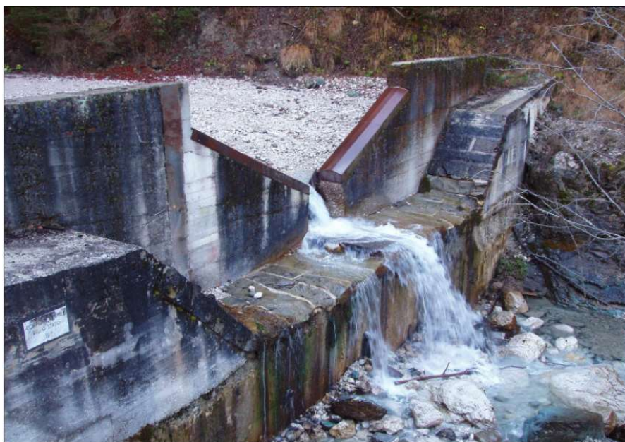
Obr. 10: Měřicí objekt průtoku na řece Missiaga. (Vianello, 2011)
