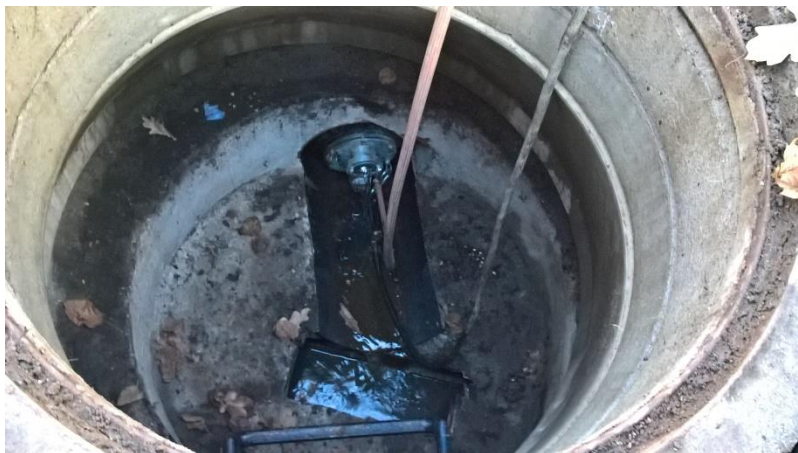
Obr. 22 Měření průtoku průtočným vakem v šachtě u Farského rybníka
