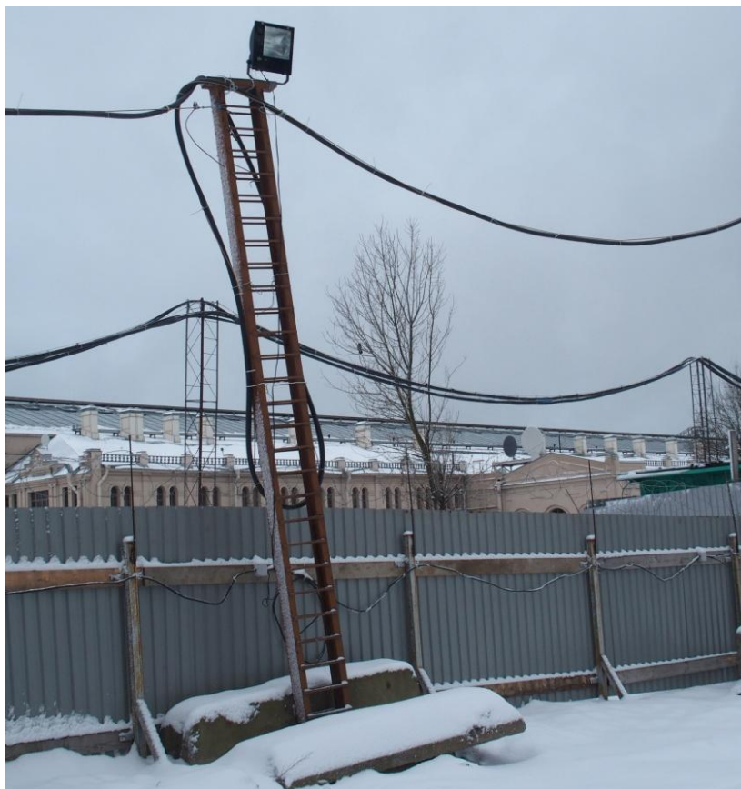
Obrázek 22: Zajištění oplocení a osvětlení objektu [zdroj vlastní]
