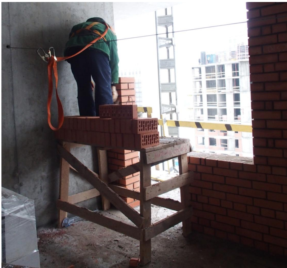
Obrázek 30: Zajištění pracovníka při práci s rizikem pádu přes volný okraj [zdroj vlastní]
