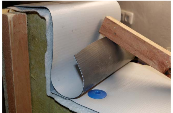
Skladba č. 3: Přesah PVC-P fólie přes kotvu mechanicky kotví tepelnou izolaci a hydroizolaci
