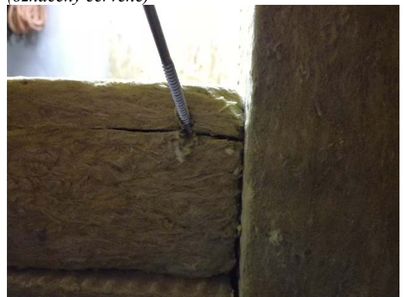
Skladba č. 3: Vodorovná trhлина při šířce desky
