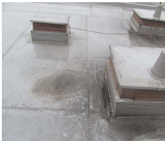
Obr. 3: Tvorba kaluže u komor VZT na střeše s hydroizolací z PVC fólie (převzato z posudků DEKPROJEKT s.r.o.)
