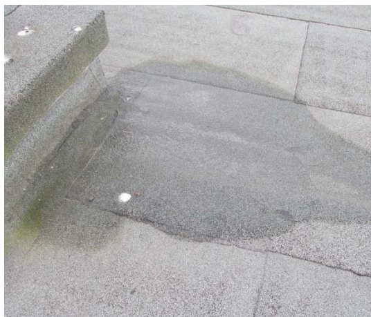
Obr. 5: Tvorba kaluže u komor VZT na střeše s hydroizolací z asfaltových pásů (převzato z posudků DEKPROJEKT s.r.o.)
