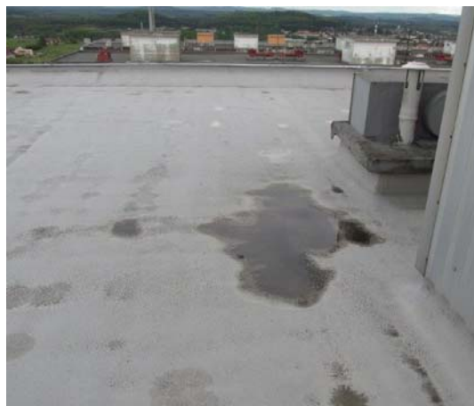
Obr. 4 Tvorba kaluže u komor VZT na střeše s hydroizolací z PVC fólie (převzato z posudků DEKPROJEKT s.r.o.)
