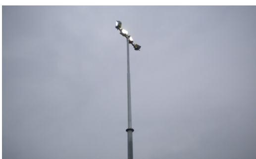
Obr. 70 - Osvětlovací stožáry ZS; užity typizované, opakovaně použitelné osvětlovací prvky
