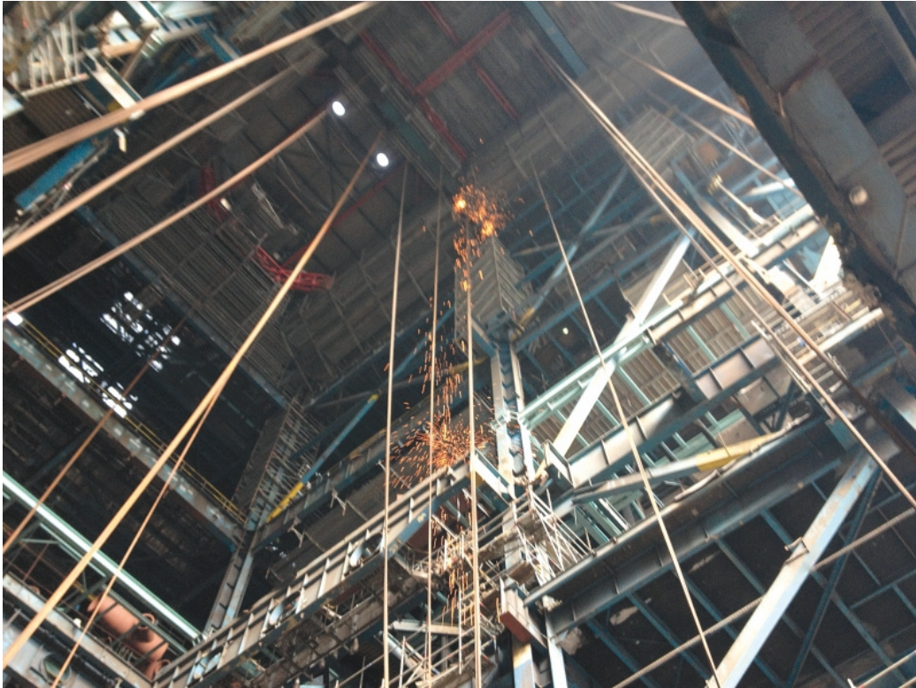
Obr. 52 – Technologie demontáže kotlů; extrémně náročné prostorové a další podmínky jsou obvyklé (je třeba s tím počítat a včas provést dostatečnou přípravu)
