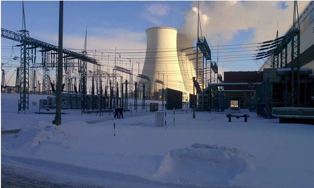
Obr. 49 – Záběr na rozvodnu s vývodem el. výkonu EPR do elektrizační soustavy; technické řešení lze rovněž modernizovat s užitím BT (viz Kapitola 5.3 ); s uplatněním tohoto řešení bude k dispozici relativně rozsáhlá volná plocha, využitelná např. pro zvětšení plochy vnitroareálové zeleně
