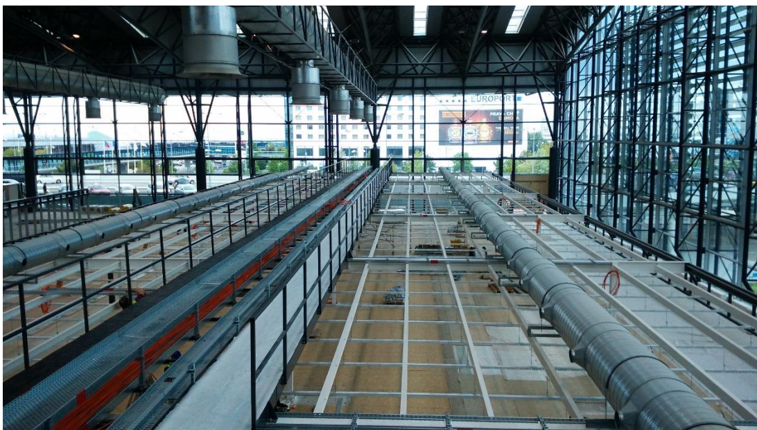
Obr. P17.8: 16. 8. 2017 – 25. týden – Pohled na „střešku“ pergoly z galerie – dokončená servisní lávka a páteřní rozvody VZT. (Zdroj: archiv autora)
