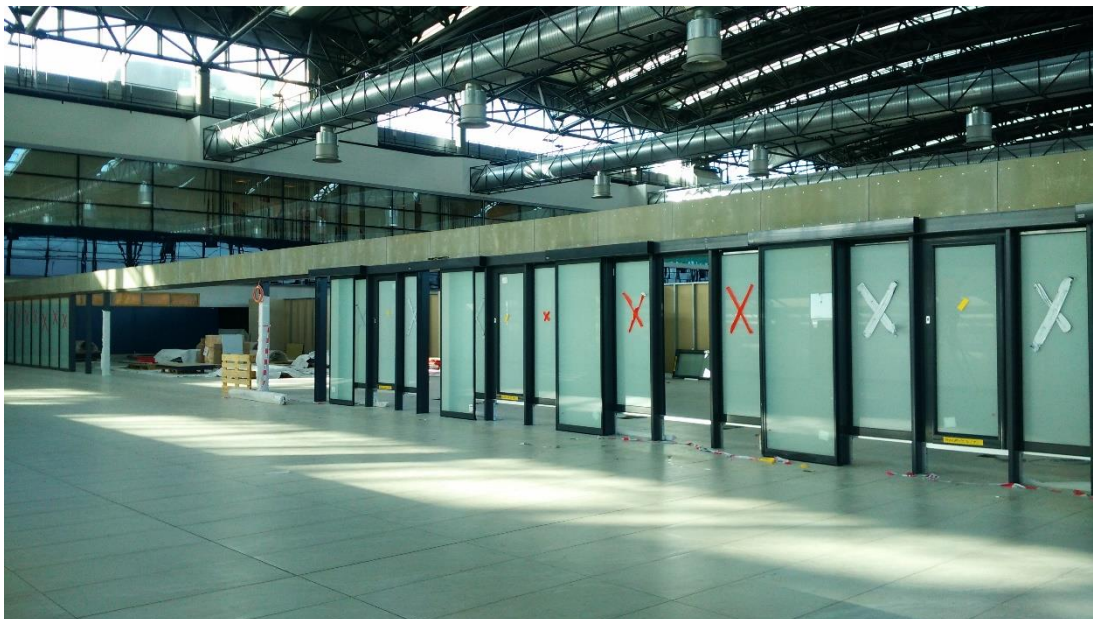
Obr. P17.11: 14. 11. 2017 – 38. týden – Dokončené prosklení příčky P13, chybí opláštění. (Zdroj: archiv autora)
