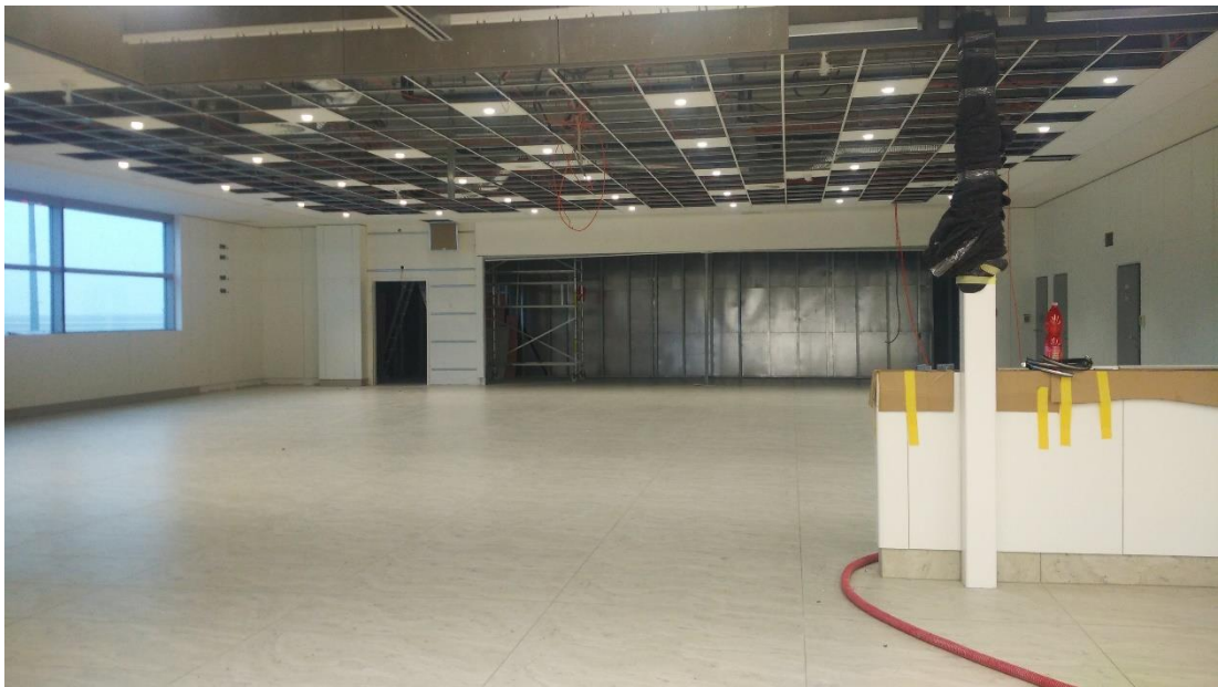
Obr. P17.14: 29. 11. 2017 – 40. týden (další avizovaný termín dokončení) – Stavební dokončenost průchodu z COB do komerční zóny – zábor je hranicí SRA. (Zdroj: archiv autora)
