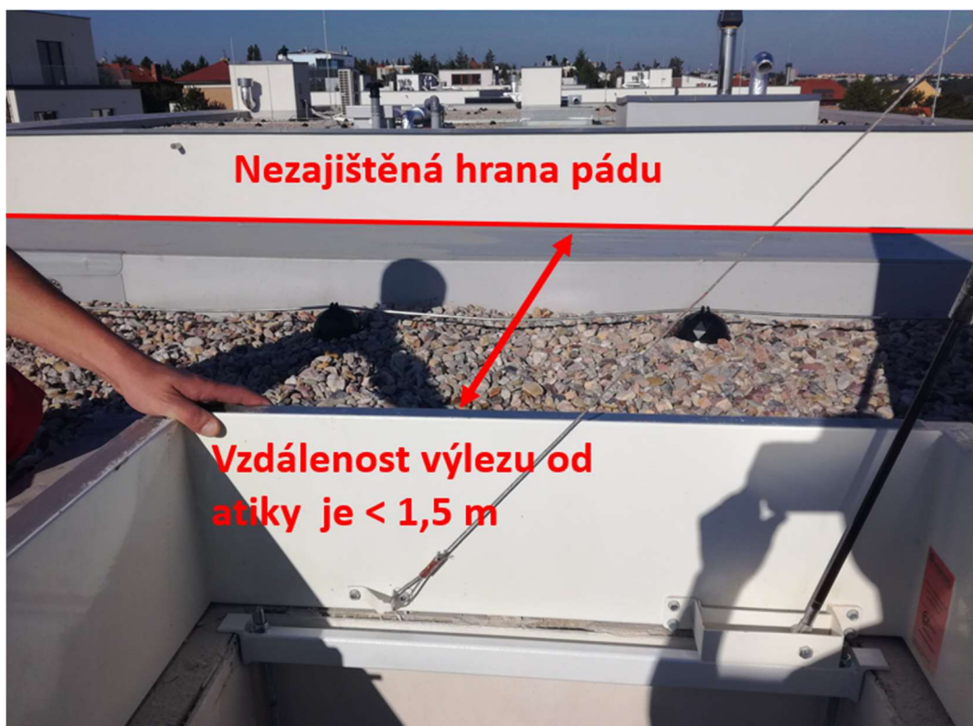
Obrázek 42 - Nevhodně umístěný výlez v blízkosti nezajištěné hrany pádu (Zdroj: vlastní)
