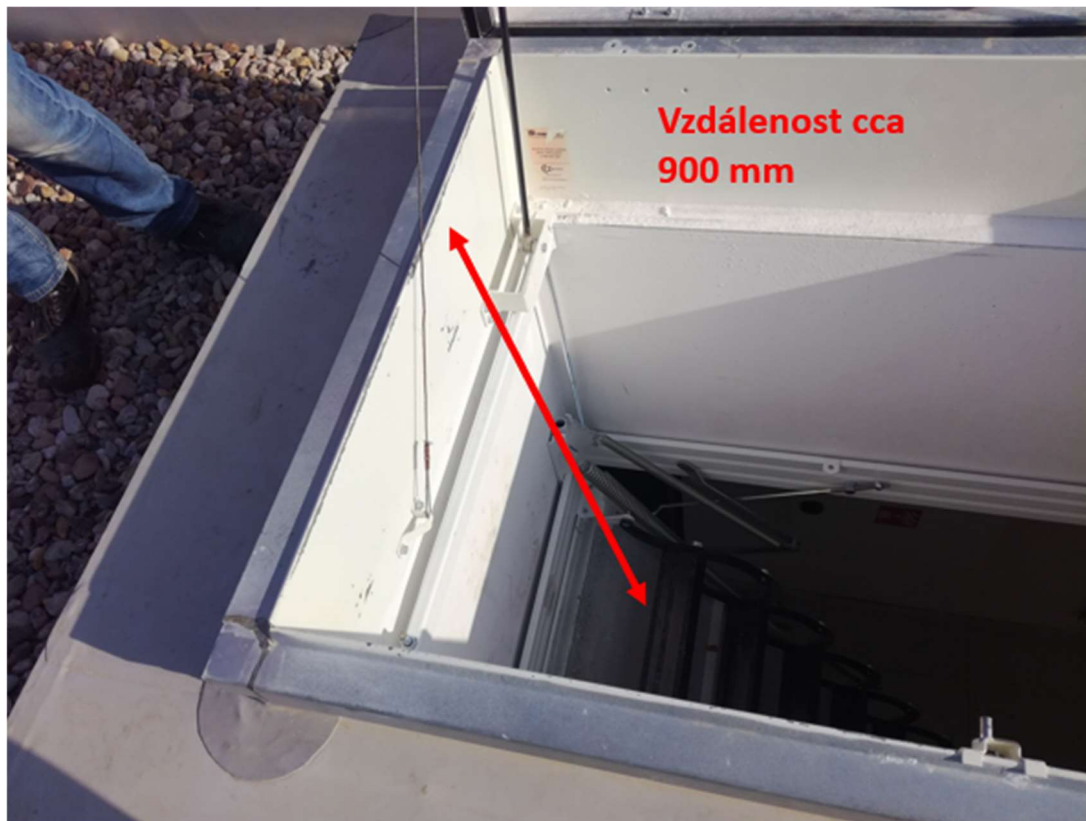
Obrázek 40 - Nebezpeční sestup ze střechy
