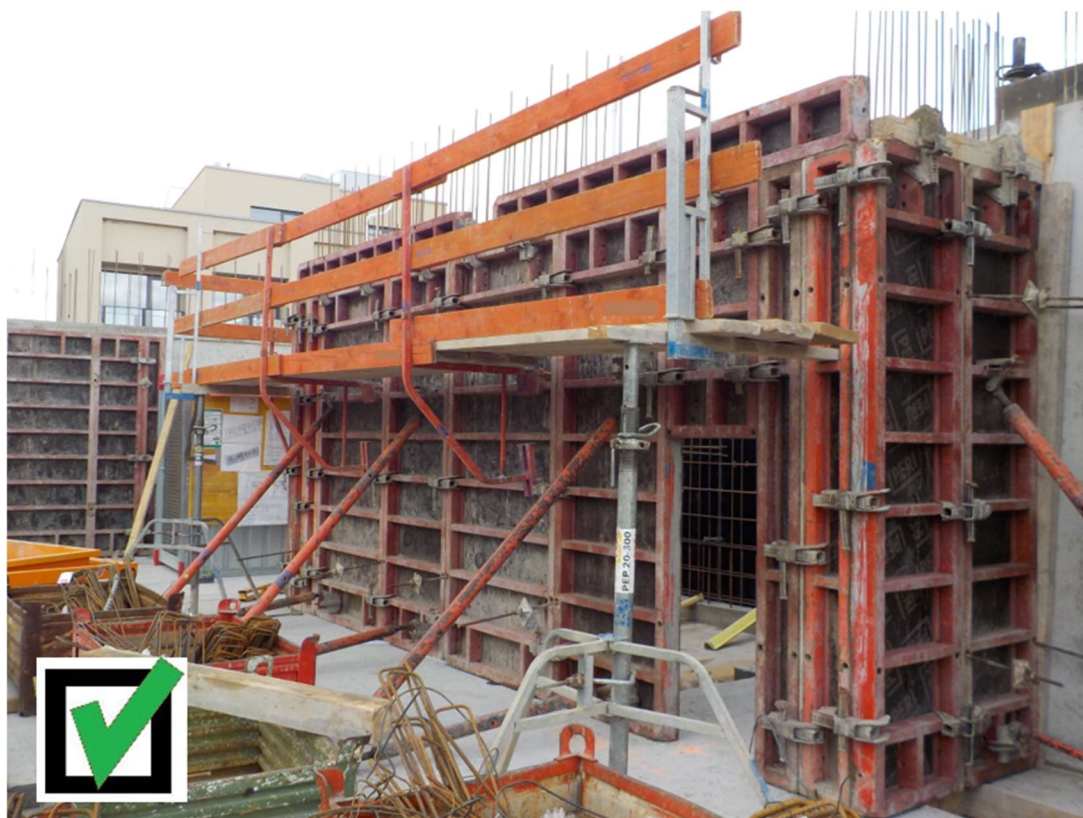
Obrázek 24 - Systémové lávky pro bednění
