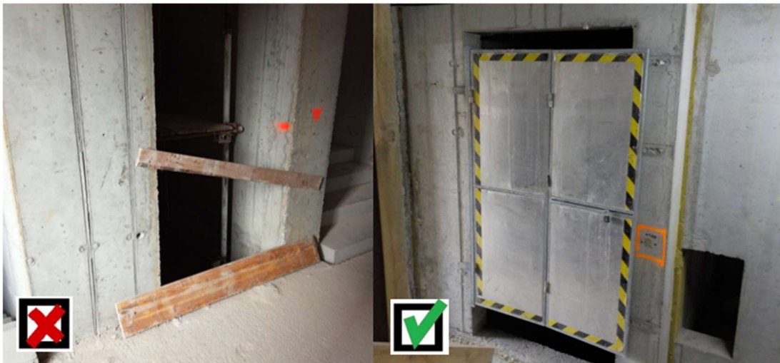
Obrázek 37 - Ochrana proti pádu z výšky do výtahové šachty
