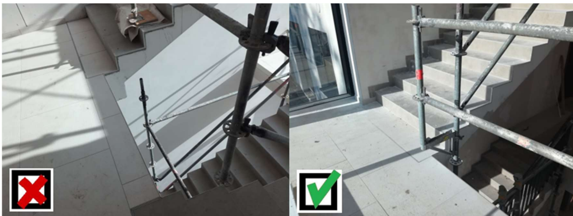
Obrázek 36 – Práce ve výšce v blízkosti schodišťového prostoru
