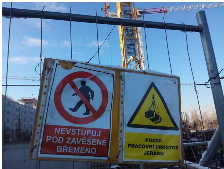
Obrázek 7 - Zákaz vstupu pod zavěšené břemeno
