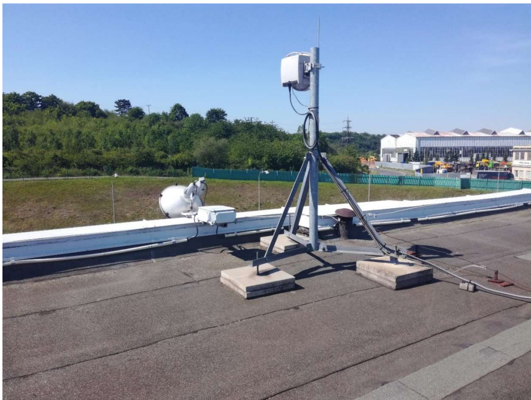
Obrázek 43 - Nevhodně umístěné zařízení v blízkosti hrany pádu (Zdroj: vlastní)
