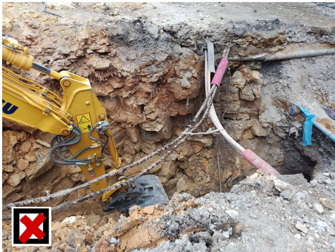
Obrázek 19 - Nedodržení odstupových vzdáleností od sítí technické infrastruktury 3
