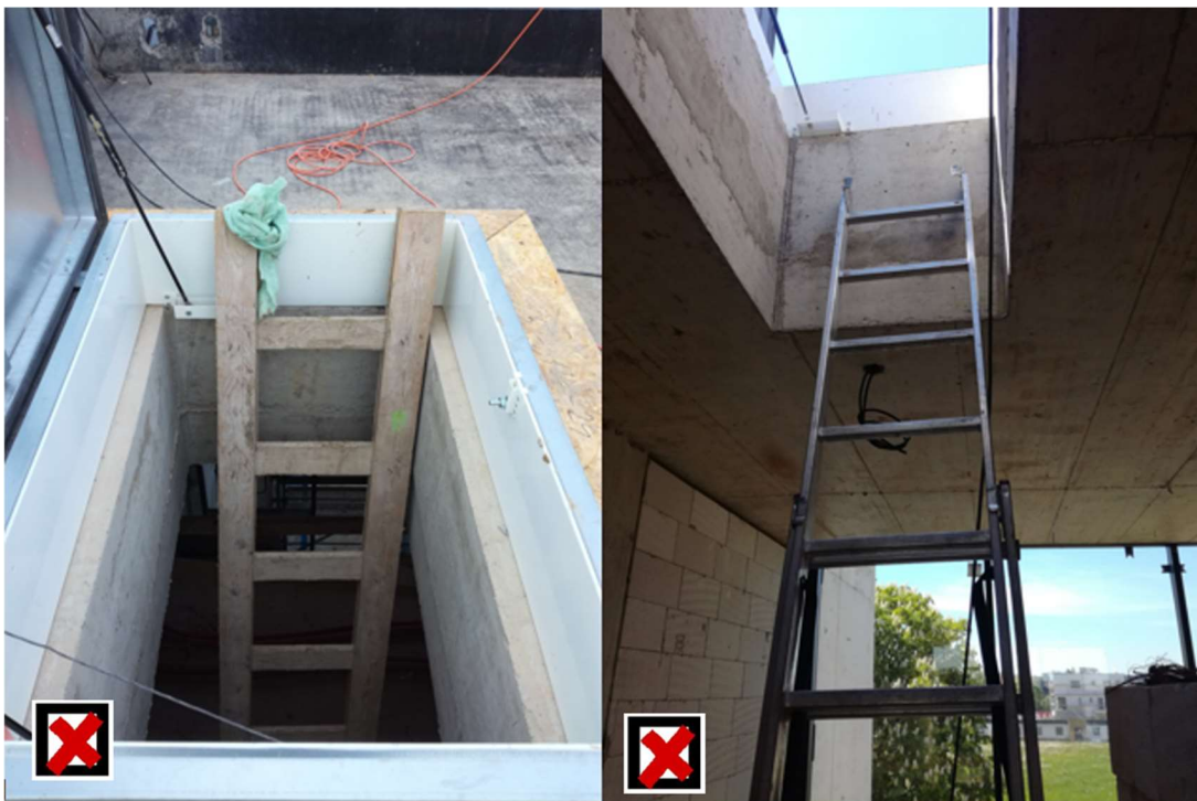
Obrázek 44 - Nedostatečný přesah žebříku
