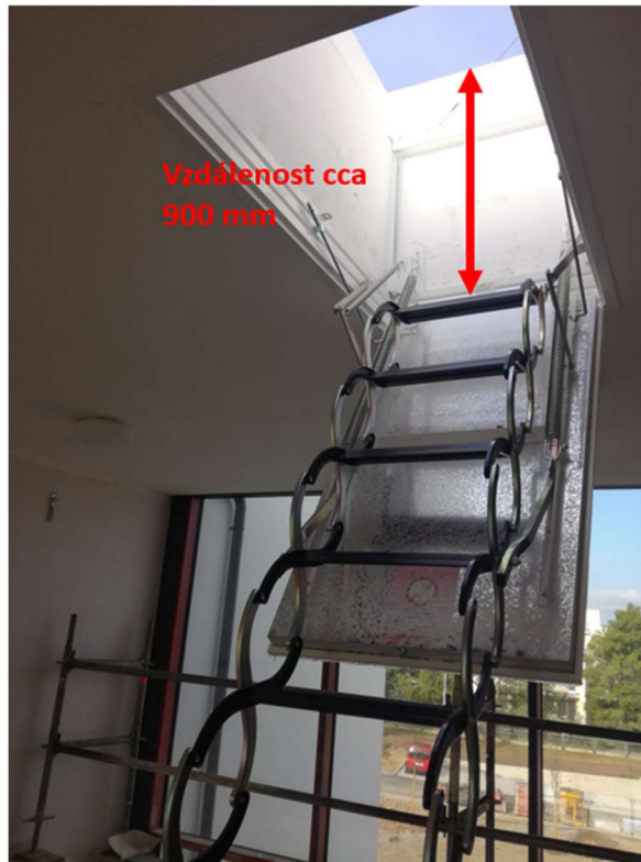
Obrázek 39 - Nevhodný výstup na střechu (zdroj: vlastní)
