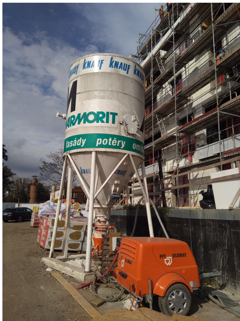
Obrázek 4.4: Silo volně ložené omítky vč. dopravníku (archiv autora)
