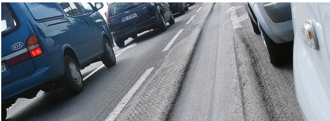
Obrázek 8 - Povrch asfaltového krytu – vyjeté koleje
