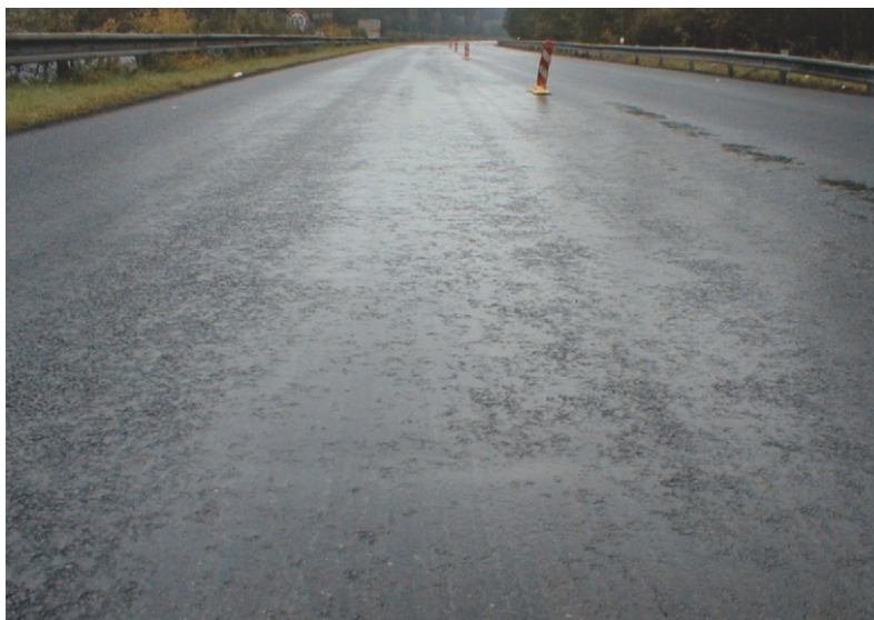
Obrázek 2 - Pokládka asfaltového koberce – vystoupení asfaltu
