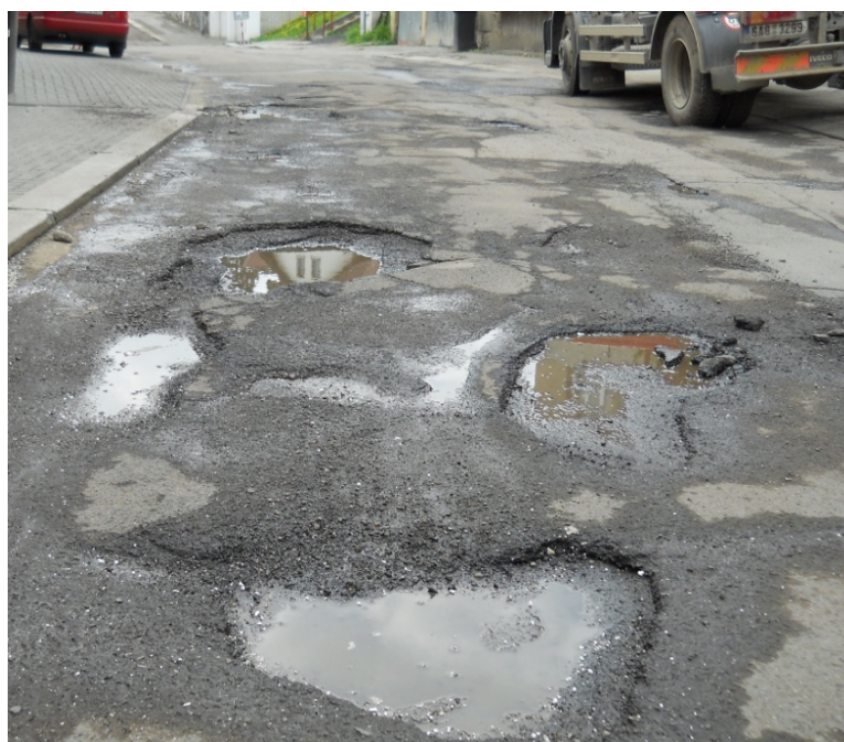
Obrázek 7 - Povrch asfaltového krytu – výtluky na vozovce
