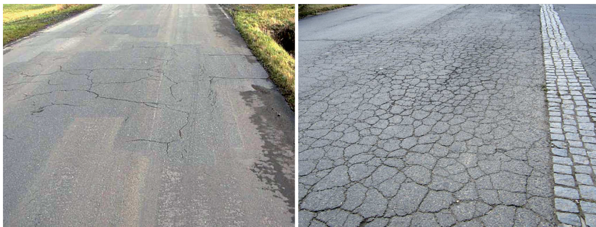
Obrázek 9 - Povrch asfaltového krytu – mozaikové trhliny/síťové trhliny
