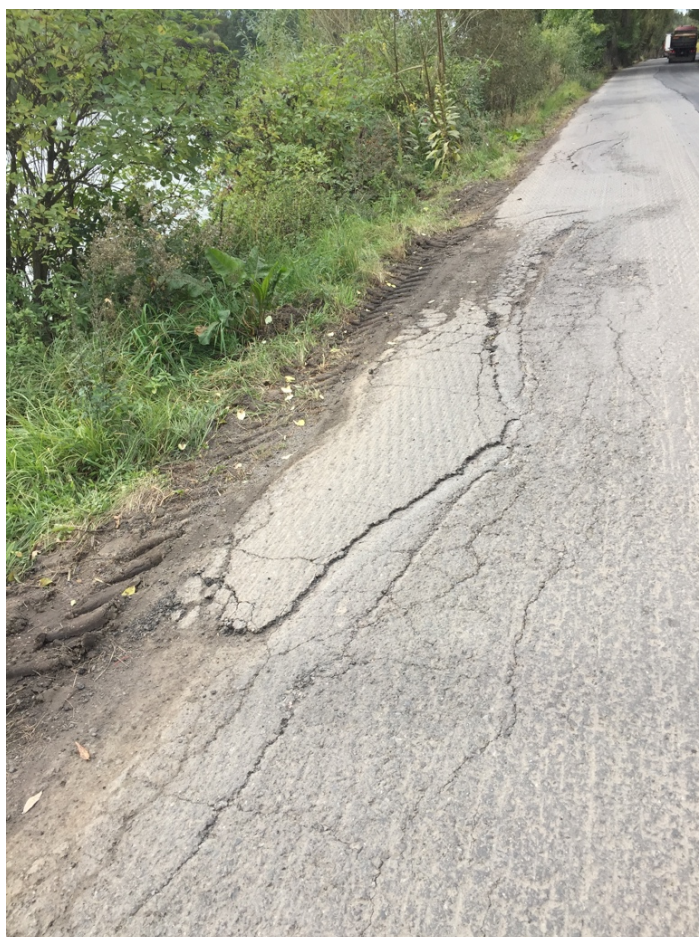
Obrázek 23 - Pokles okraje vozovky
