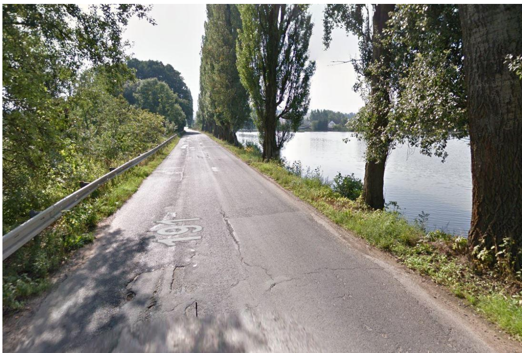
Obrázek 21 - Pohled na poškozenou vozovku
