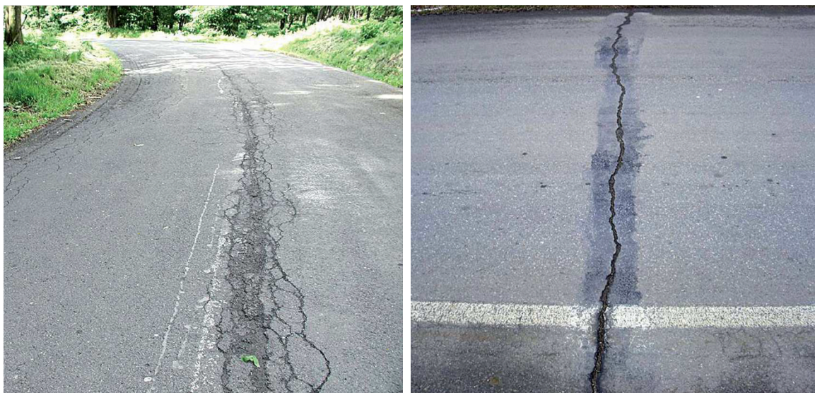
Obrázek 10 - Povrch asfaltového krytu – trhliny podélné/příčné
