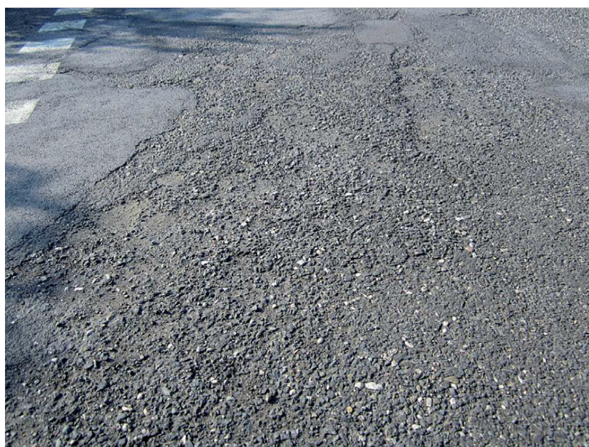
Obrázek 6 - Povrch asfaltového krytu – hlubková koroze
