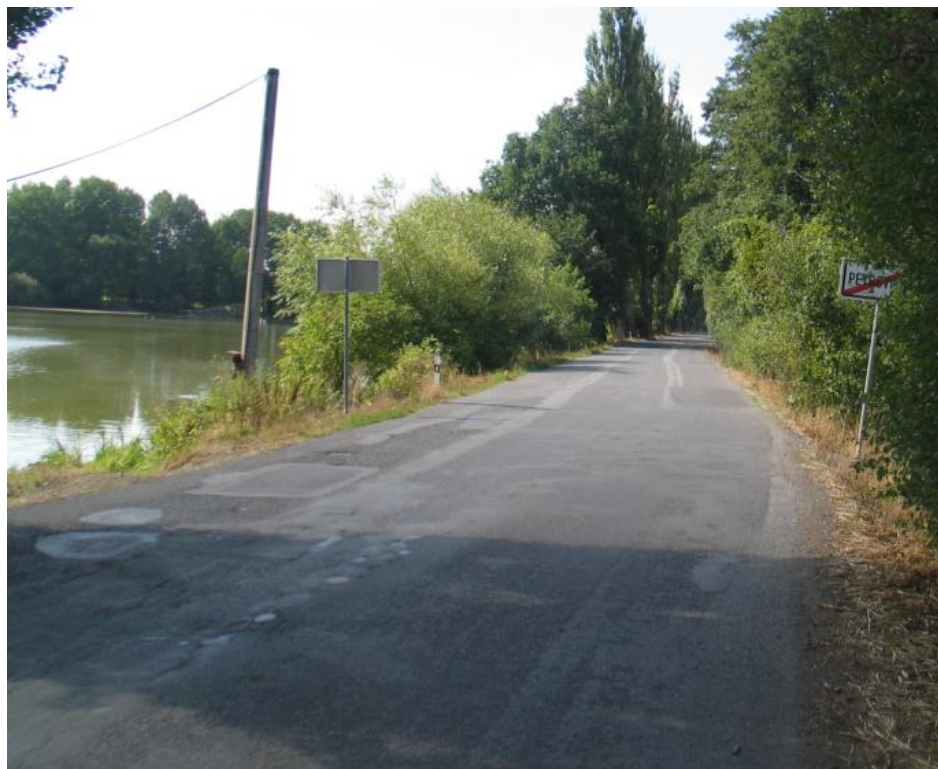
Obrázek 22 - Pohled na poškozenou vozovku
