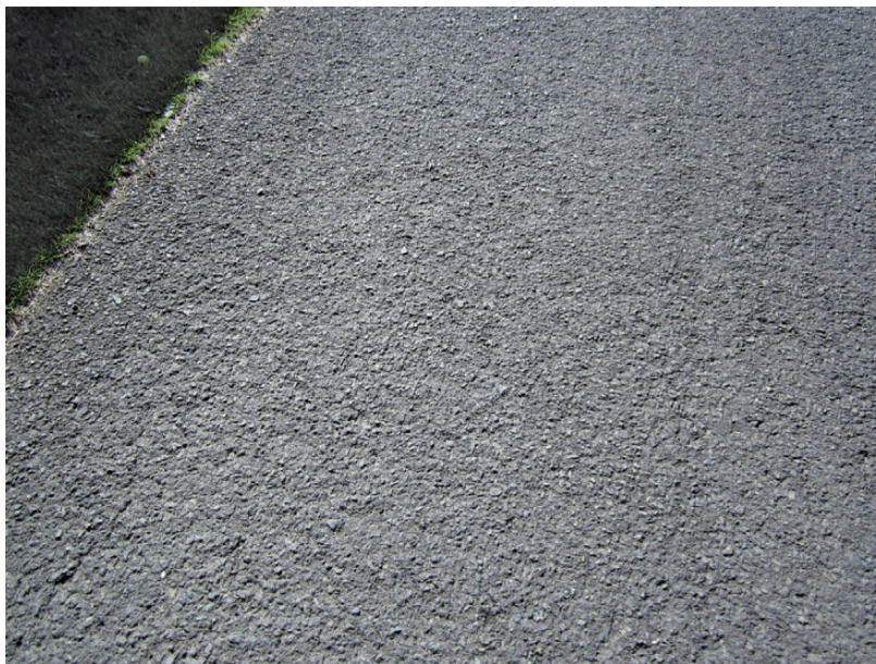
Obrázek 5 - Povrch asfaltového krytu – ztráta asfaltového tmelu
