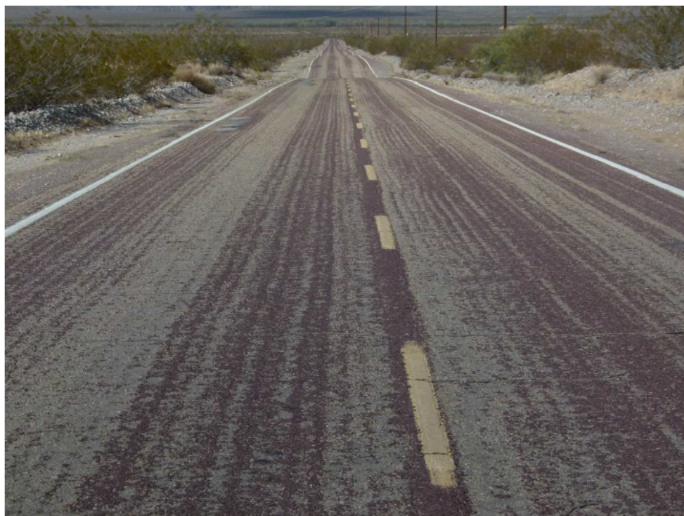
Obrázek 4 - Povrch asfaltového krytu – ztráta kameniva z nátěru
