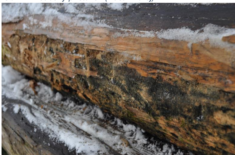
Obr. 13 Porušené roubení (vlastní zdroj)
