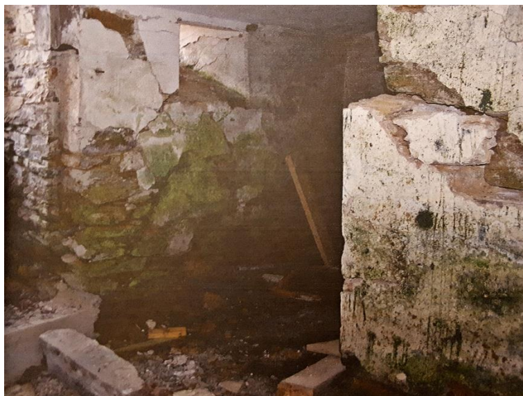
Obr. 10 Sklepní prostor - narušení zdiva (vlastní zdroj)
