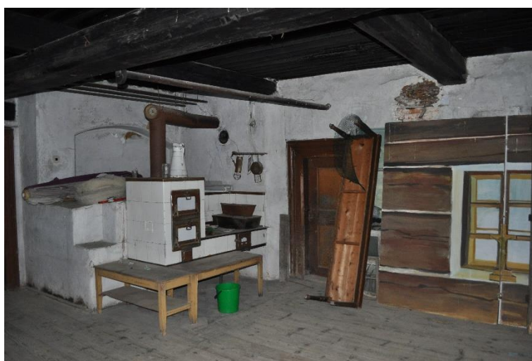
Obr. 14 Porušení původní omítky (vlastní zdroj)
