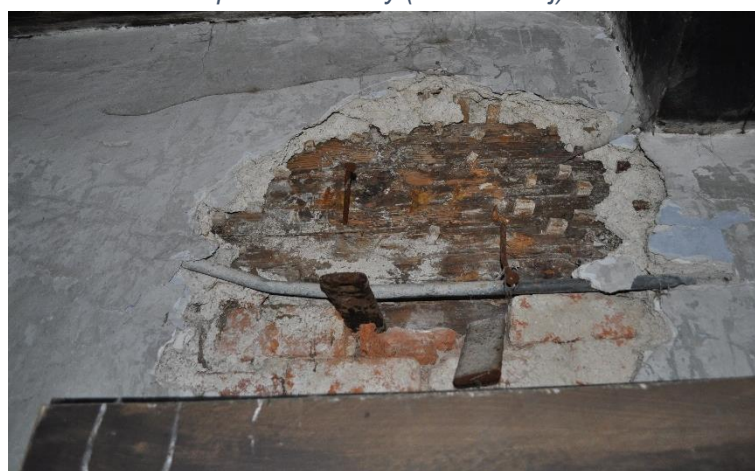
Obr. 15 Detail porušení (vlastní zdroj)
