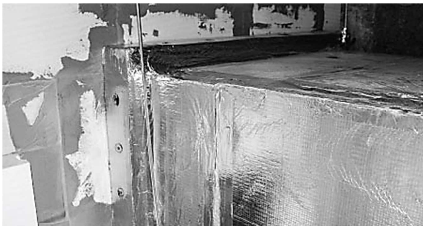
Obr. 19 Prostup potrubí požárně dělící stěnou 13
