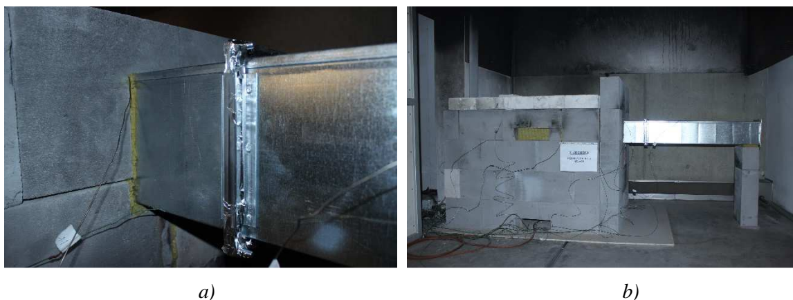
Obr. 53 Zkouška PZ2 – potrubí vně pece: a) utěsnění prostupu a přelepení přírub; b) finální podoba zkoušky
