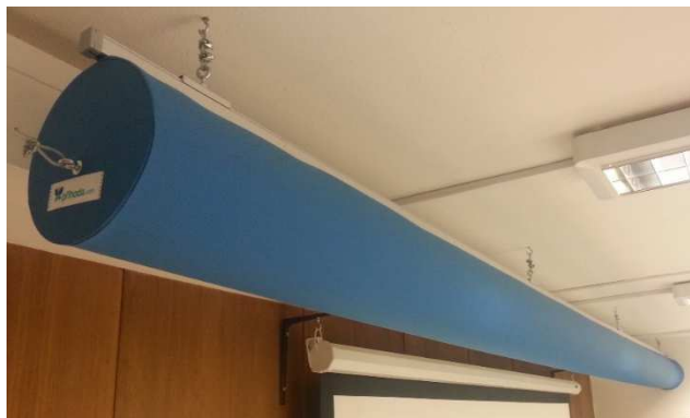
Obr. 12 Textilní vyústka v učebně fakulty stavební ČVUT v Praze
