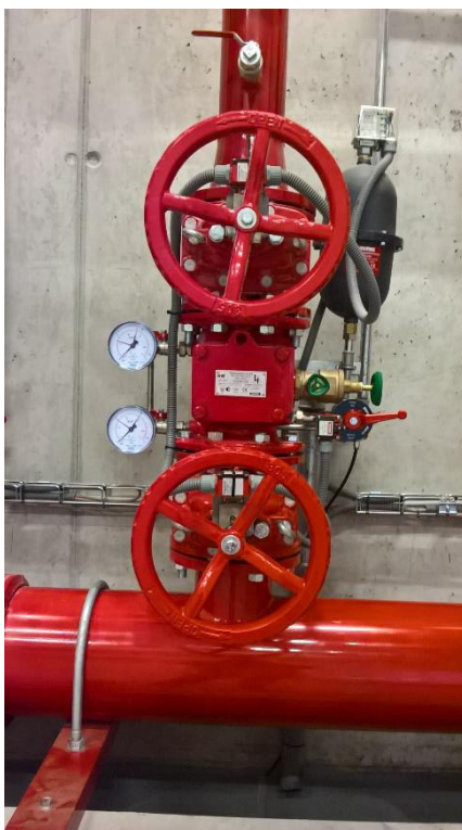
Obrázek 8 - Mokrý ventilová stanice firmy Minimax
