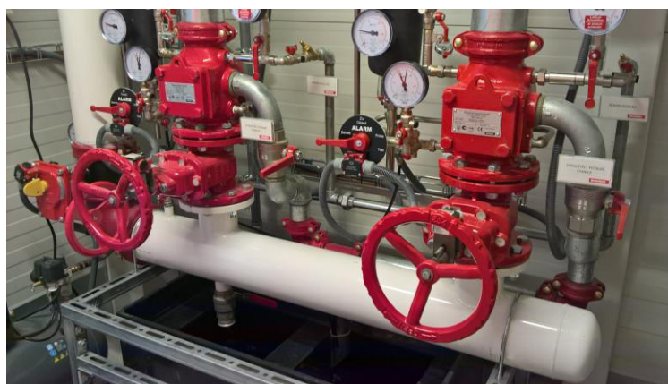
Obrázek 6 - Suché ventilové stanice SVS08 a SVS09
