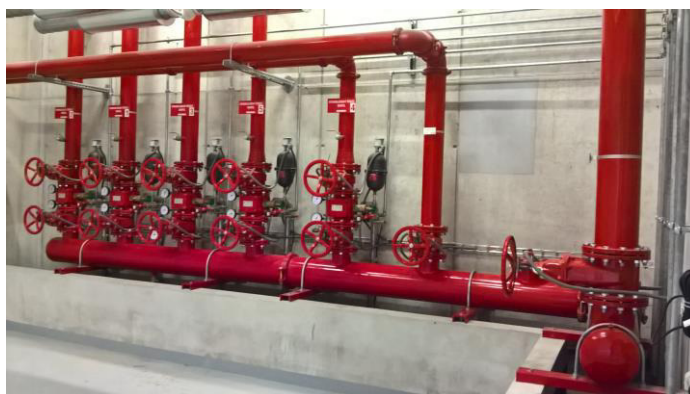
Obrázek 4 - Rozdělovač v hlavní místnosti ventilových stanic (budova IH)
