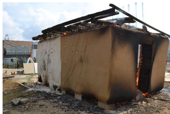
Obr. 40 Pohled na severní obvodovou stěnu před celkovým kolapsem
