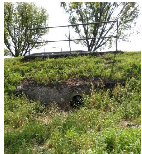
Obrázek 28 Mělnické Vtelno propustek
