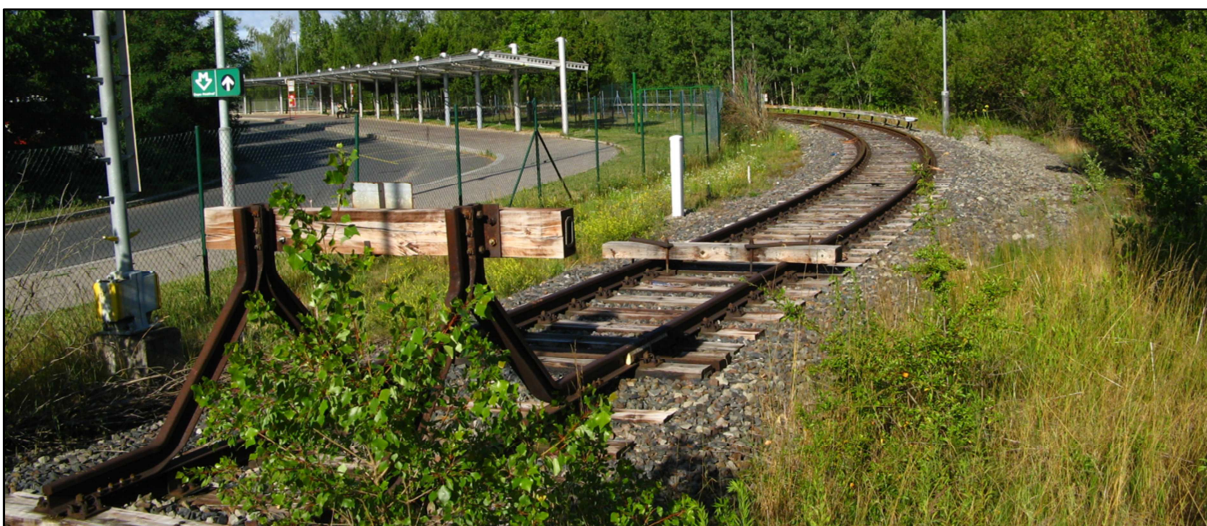
Obrázek 10: Kusá (výtažná) kolej metra slouží pro úvrat', kterou se soupravy metra dostanou z obvodu stanice Depo Hostivař na zkušební trať a také do haly dlouhodobějších oprav. Je však velmi zřídka využívána a do velké míry limituje možnosti přivedení tramvajové trati.
