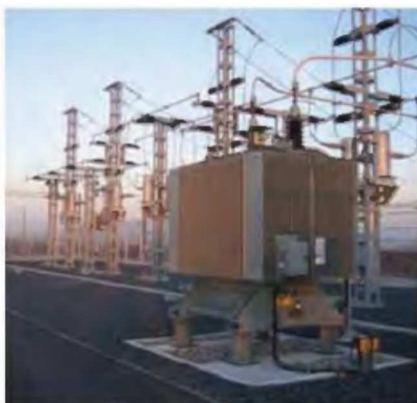
Obrázek 3 Autotransformátor na širé trati ve Francii [1]
