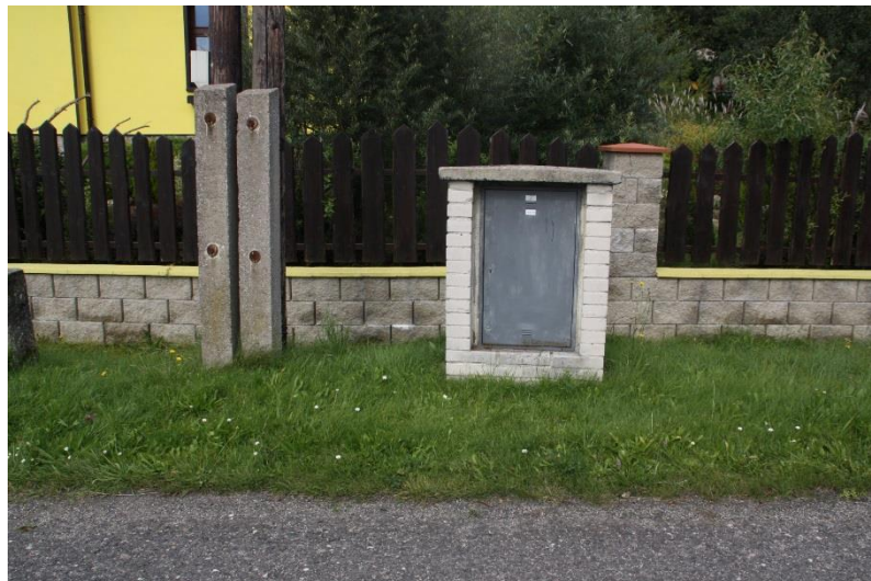
Obrázek 9 Stávající skříň PSR RYNL7 v Jítravě [autor]
