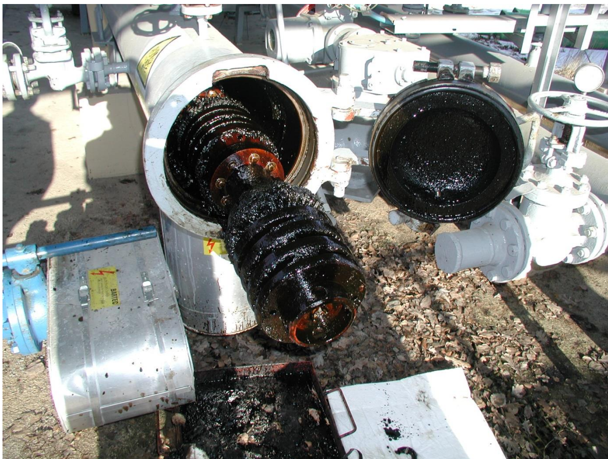
Obrázek 16 – Čistící ježek v potrubí [7]
