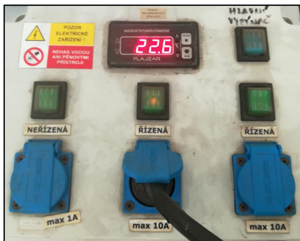
Obrázek 38. Řídicí panel kondenzační komory.
