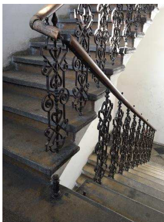
Obrázek 45: Ukázka chybějícího prvku výplně zábradlí
