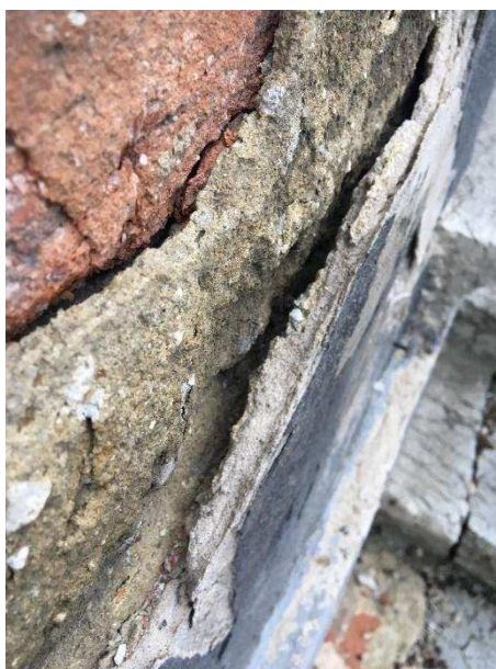
Obrázek 79: Detail odfouknuté fasády
