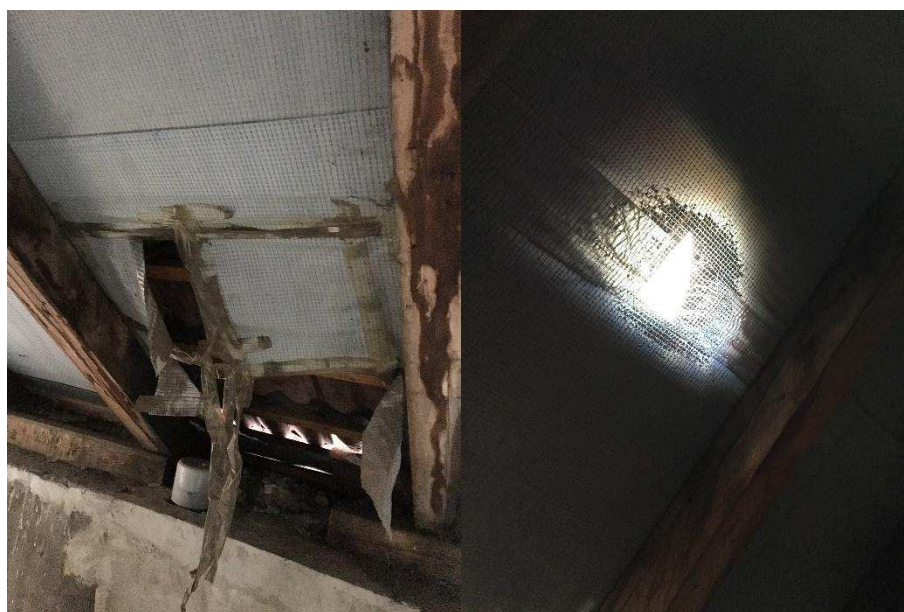
Obrázek 55: Poškození a degradace hydroizolace
