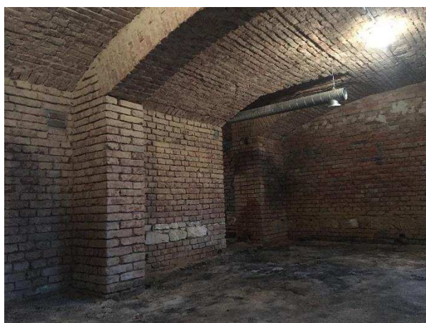
Obrázek 13: Vykližené suterénní prostory, stěny bez omítek,
