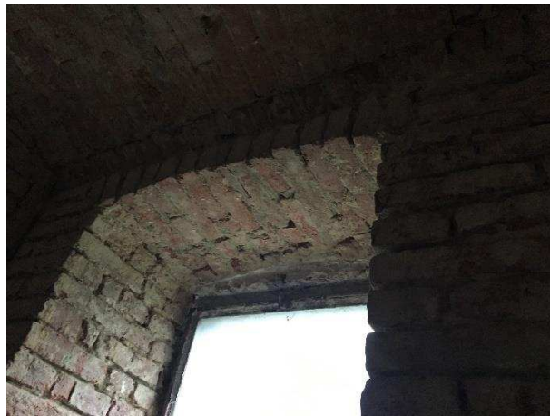
Obrázek 32: Záklenek nad oknem v suterénu
