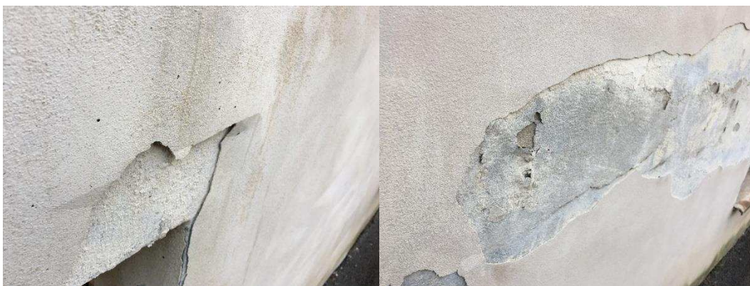
Obrázek 76: Ukázka degradace omítky severní fasády
