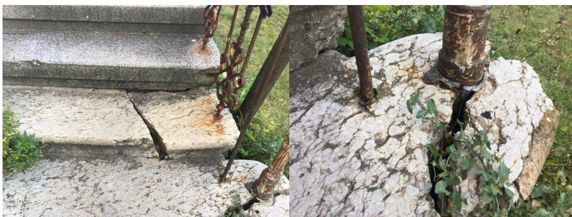
Obrázek 47: Ukázka poruch stupňů
