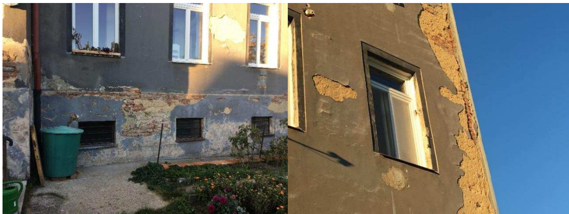
Obrázek 78: Poruchy jižní fasády
