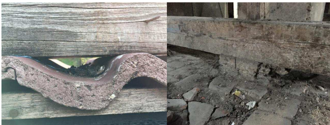
Obrázek 54: Dřevěný rám střešního výlezu a degradace bačkory
