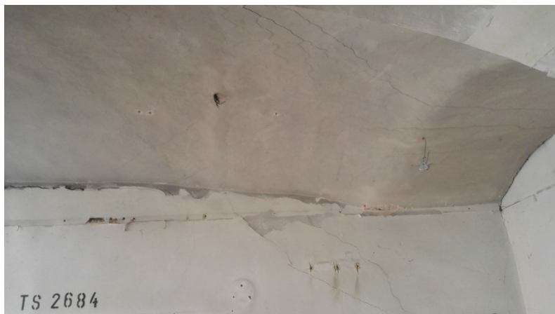
Obr. 25: Vnitřní omítka- trhliny
