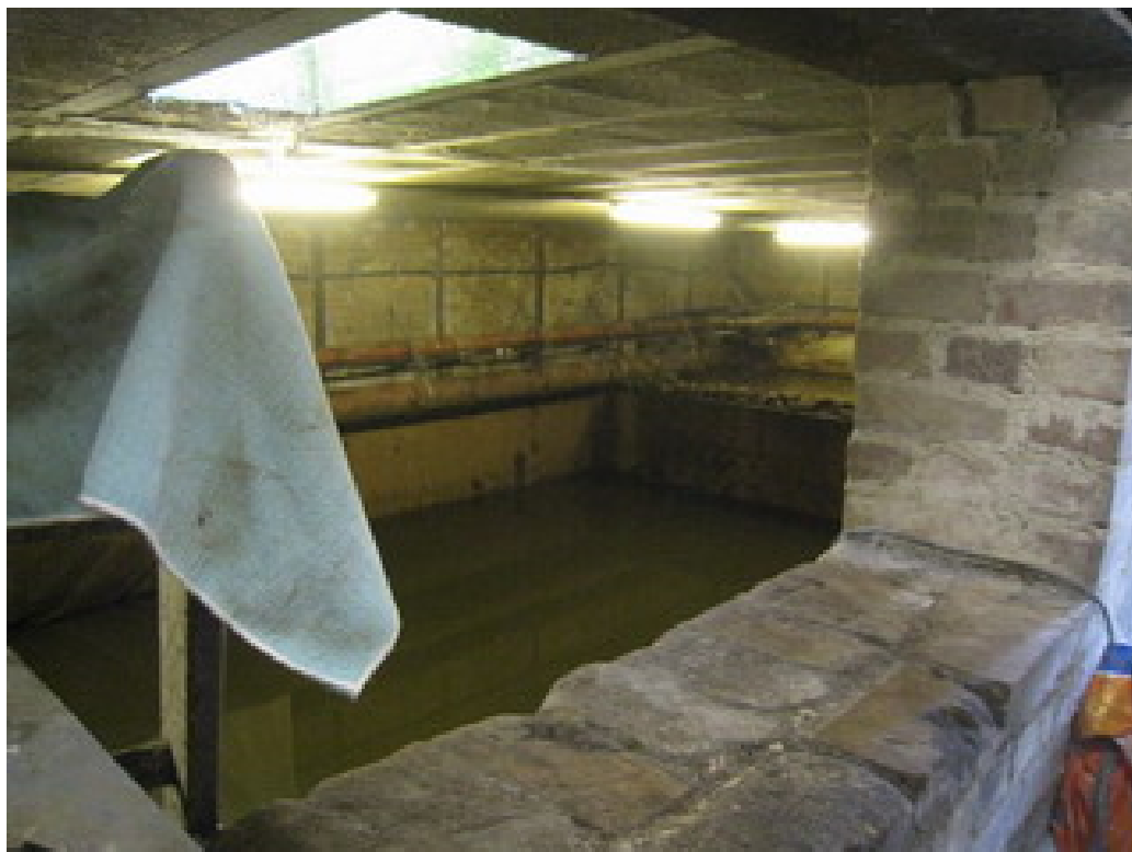
Obr. 58 Podzemní nádrž na 300 m 3 dešťové vody pro toalety [80]
