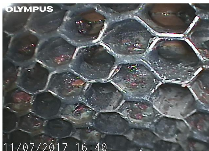
Obr. 45 Výstup primárního okruhu po čištění
