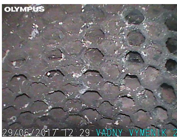
Obr. 37 Vstup primární strany výměníku před čištěním
