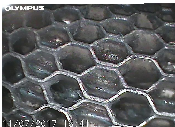
Obr. 46 Výstup primárního okruhu po čištění
