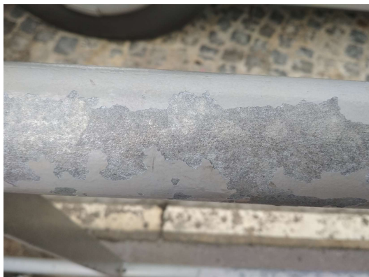
Obrázek 1: Detail nevhodné adheze nátěrového systému, ukázka zábradlí ve venkovním, atmosférickém prostředí autobusového areálu Praha, ÚAN Florenc
