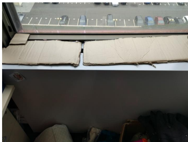
11. Předměty položené na průduších klimatizace
