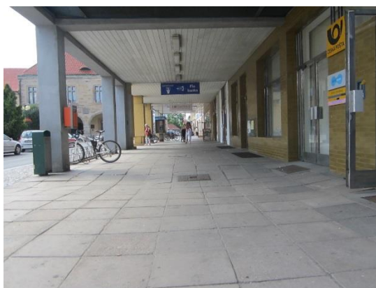
Obrázek 34 – Místní nerovnost pochozí plochy v podloubí u pošty [Autor]
