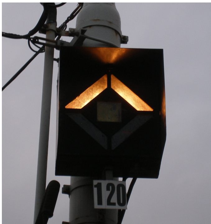
Obr. 13: Pozdější typ návěstidla v obratišti Kotlářka. Poslední návěstidlo tohoto typu bylo v září 2012 odstraněno z obratiště Kubánské náměstí (12/2008, archiv J. Hradila).
