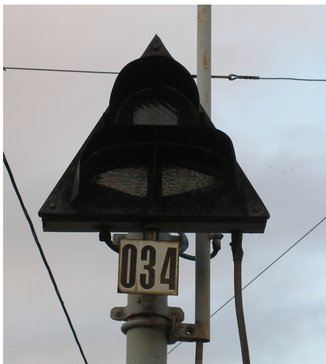
Obr. 12: Ve své době jedno z posledních výhybkových návěstidel tohoto typu na vjezdu do obratiště Podbaba, dnes již tato návěstidla v Praze nenajdeme (12/2008, archiv J. Hradila).
