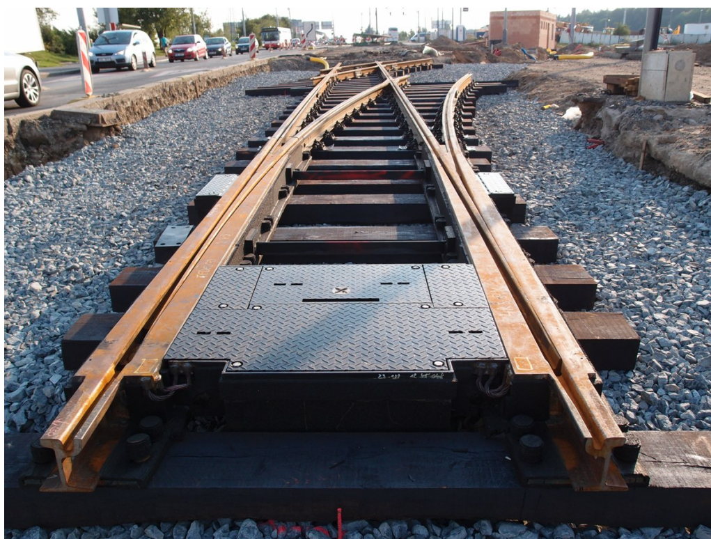
Obr. 6: Blokovaná výhybka po usazení ve vjezdu do obratiště Vypich (7/2014, archiv J. Hradila).
