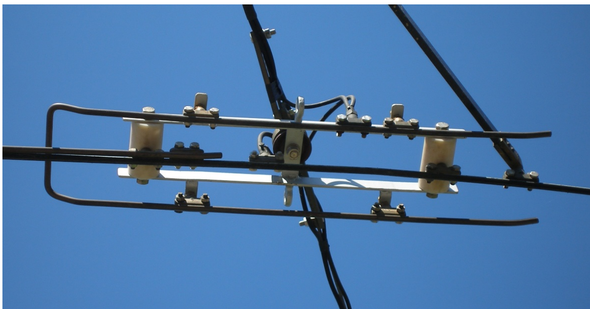
Obr. 15: Detailní pohled na pracovní trolejový kontakt, který byl svého času umístěn i v obratišti Špejchar (5/2008, archiv J. Hradila).
