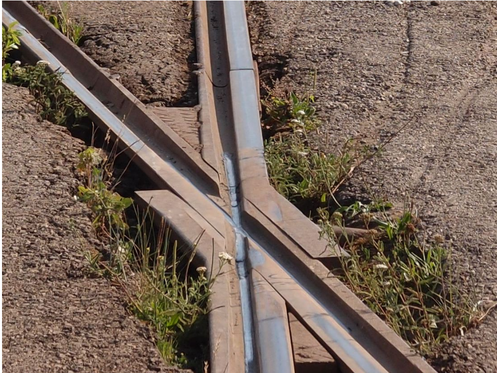
Obr. 20: Skládaná srdcovka v křižovatce poblíž zastávky SOŠ automobilová v Košicích - patrné je poškození žlábků kolejnic v místě styku jednotlivých kolejnic (7/2015, archiv J. Hradila).
