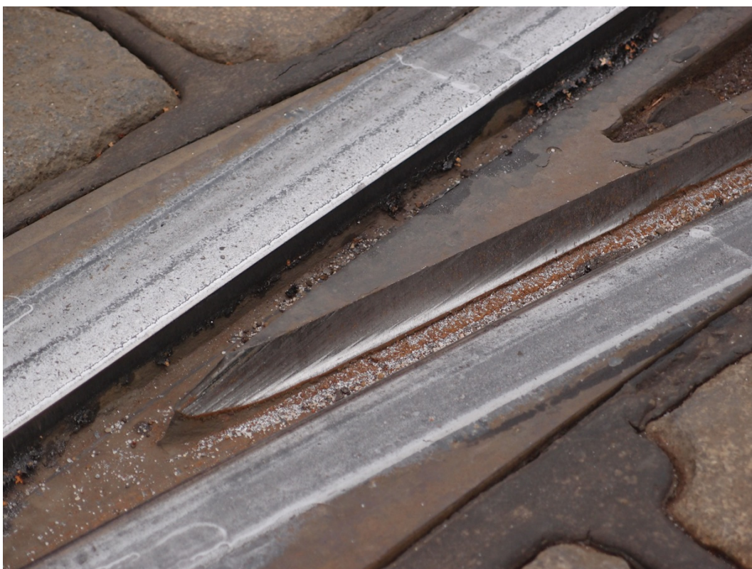
Obr. 25: Opotřeбенý hrot hluboké obloukové srdcovky sjezdové výhybky v obratišti Sídliště Petřiny (8/2016, archiv J. Hradila).
