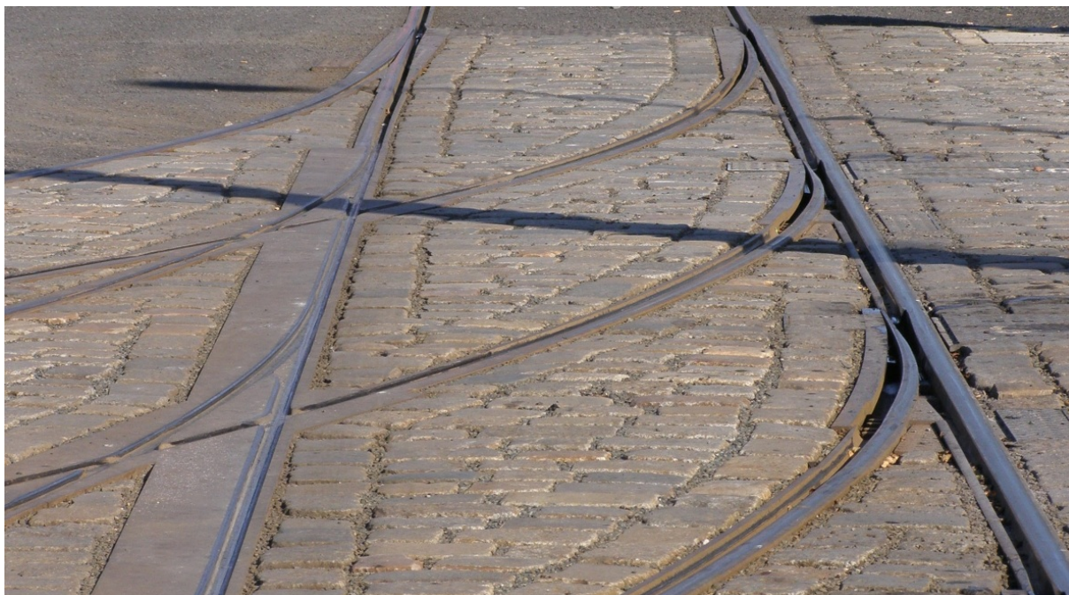
Obr. 2: Jednojazykové výhybky v kolejové harfě vozovny Kobylisy. (10/2010, archiv J. Hradila).
