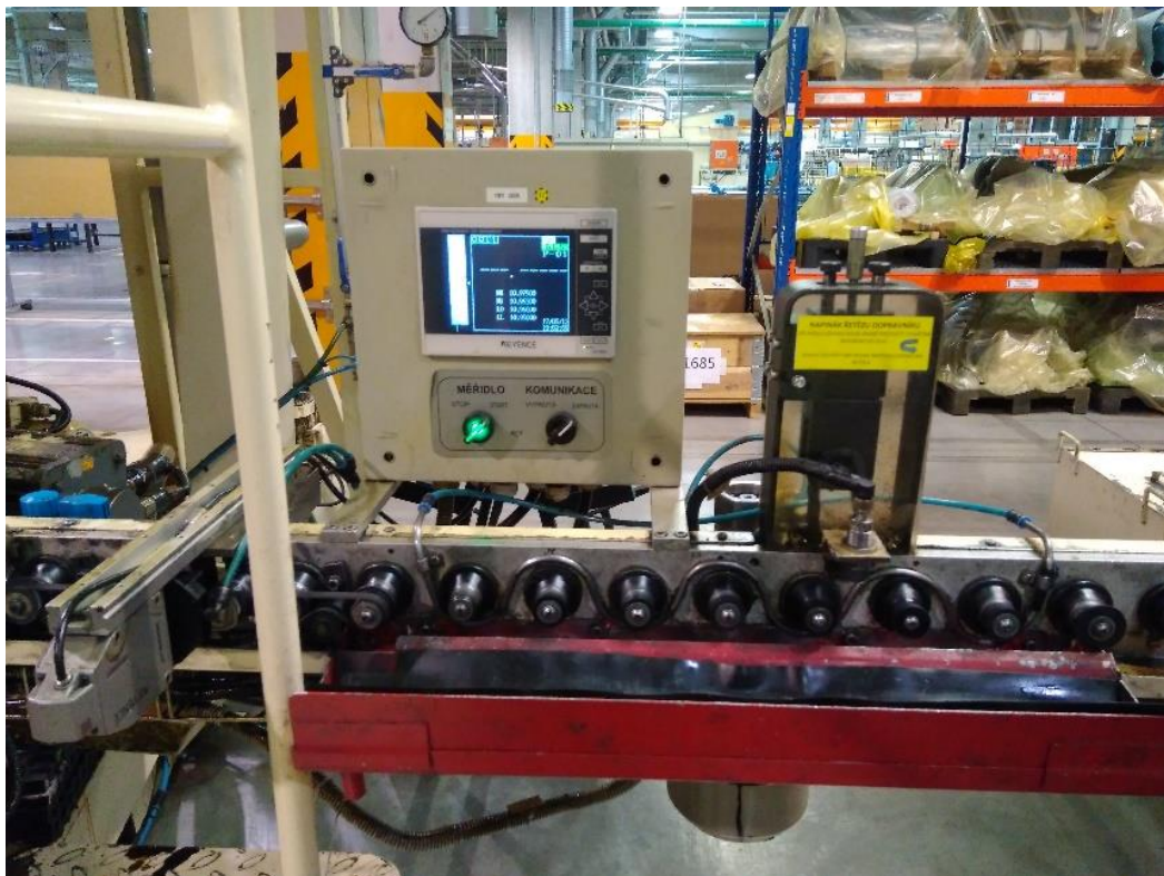
Obr. 43.: Měřicí jednotka, napínák řetězu dopravníku
