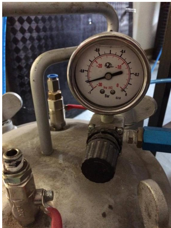
Obrázek 16 Údaj na vakuové pumpě
