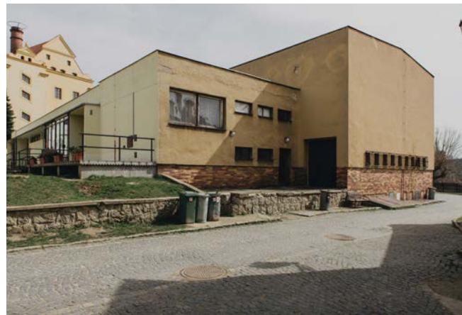
Pohled na západní fasádu kulturního domu. Nevhodné tvarosloví je na první pohled viditelné.
