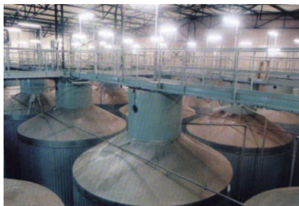
Obr. 5 Instalace tanků v budově v pivovaru Prazdroj ( www.prazdroj.cz )
