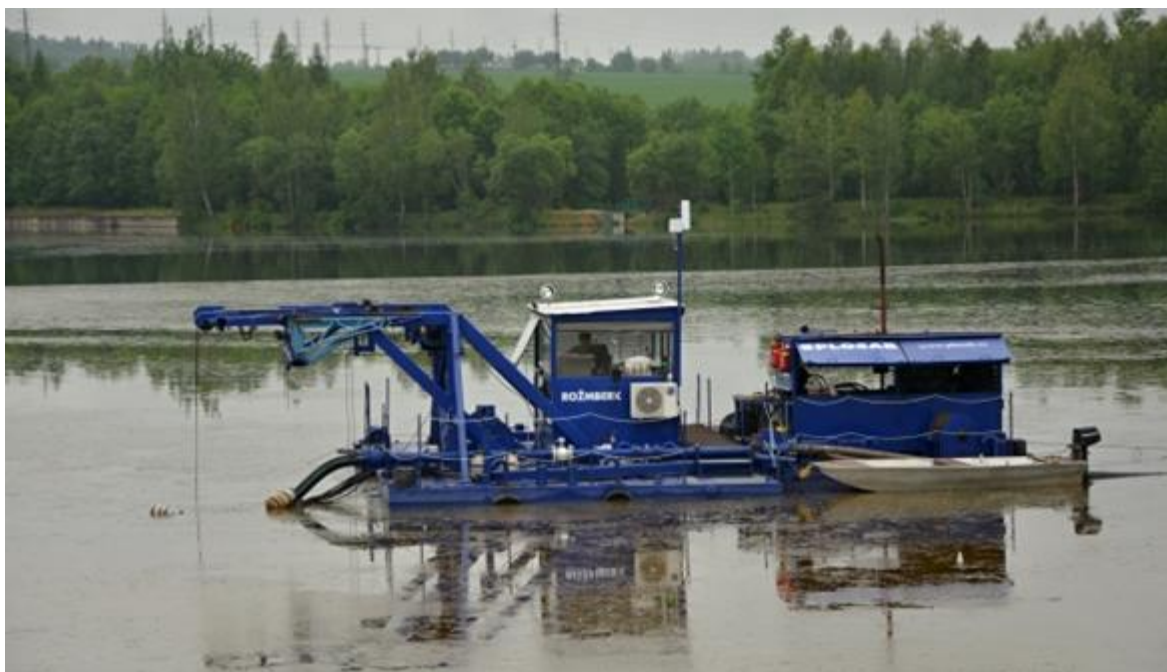
Obr. 29: Sací bagr na kalové nádrži
