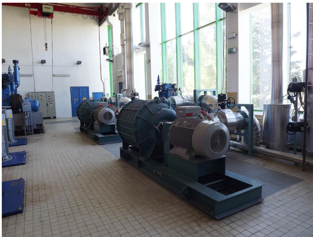
Obr. 21: Dva vzduchové kompresory
