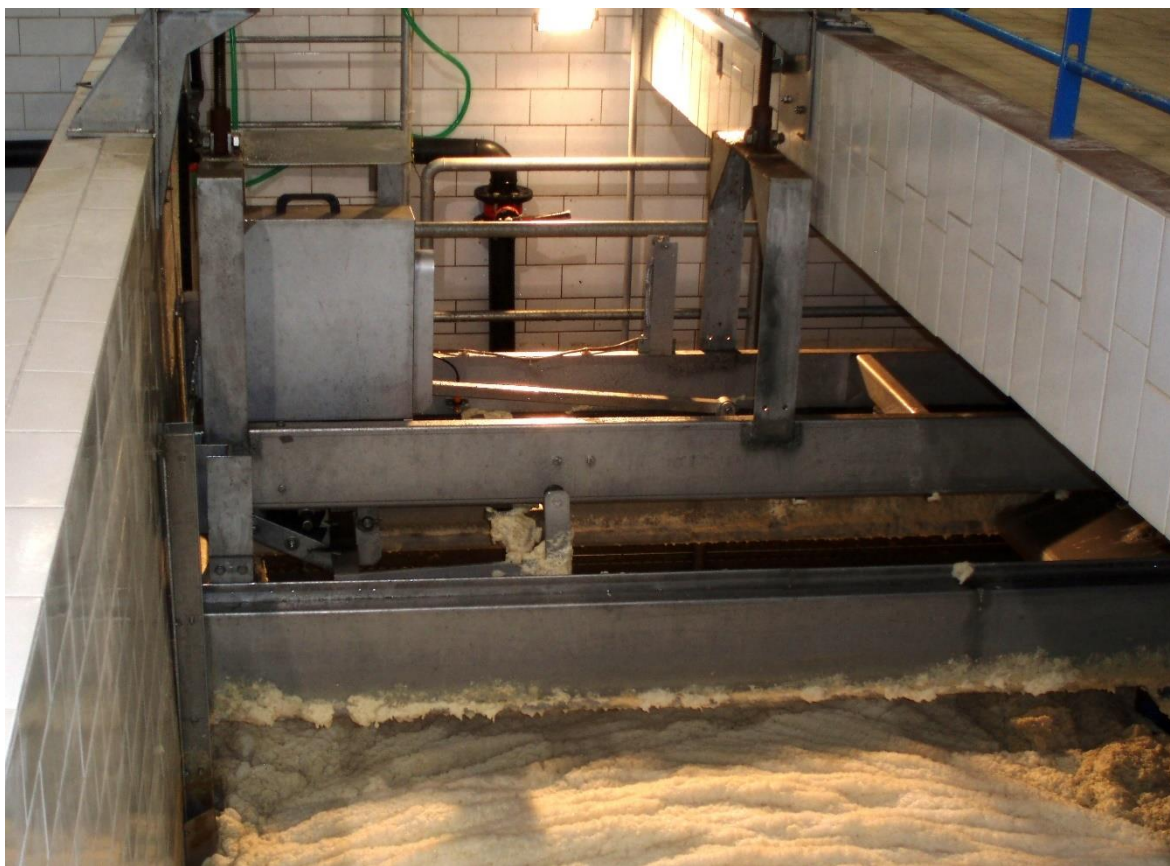
Obr. 16: Stírací zařízení na vyvločkované nečistoty
