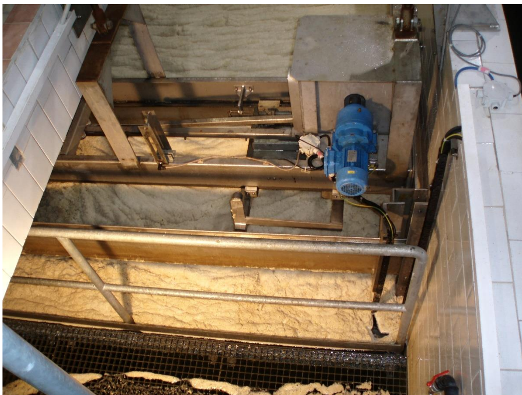
Obr. 18: Stírací zařízení na vyvločkování nečistoty
