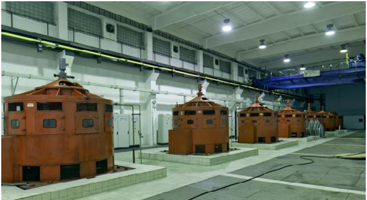
Obr. 13: Čerpací stanice surové vody
