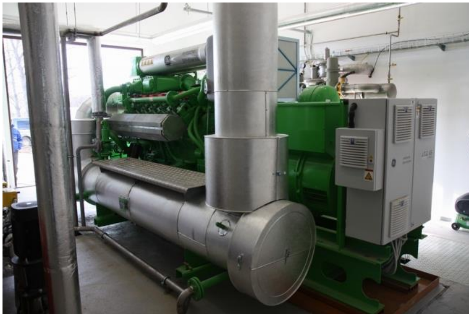
Obrázek 4 – Kogenerační jednotka BPS [10]
