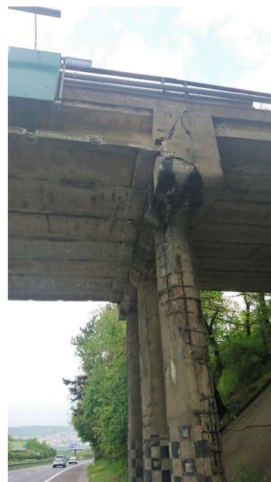
Obr. 3.3 Nevyhovující stav konstrukce K Výtopně x D4
