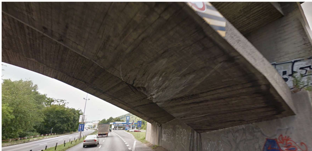
Obr. 4.11 Branický most, problém u nestejných průjezdných výšek pruhů Zdroj: [15] Strakonická
