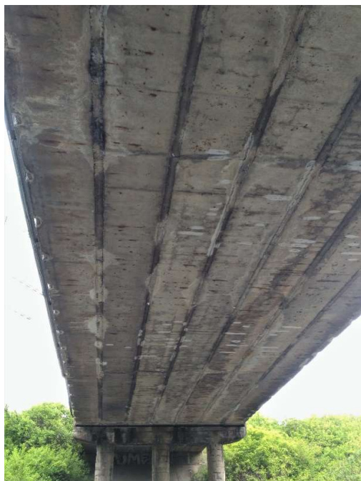
Obr. 3.4 Nevyhovující stav konstrukce K Výtopně x D4
