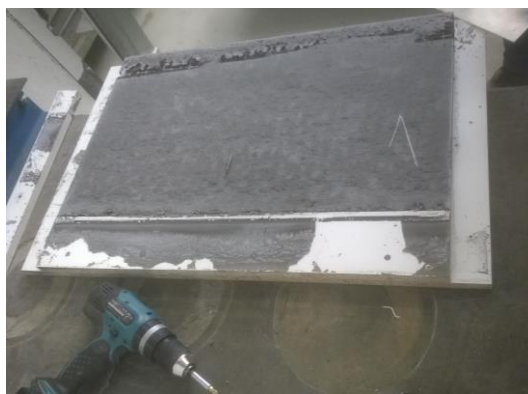
Obr. 72: Odbednění vybouleného bednění [29]
