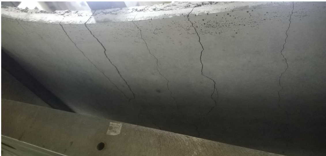
Obr. 86: Porušení betonu desky D2 [29]
