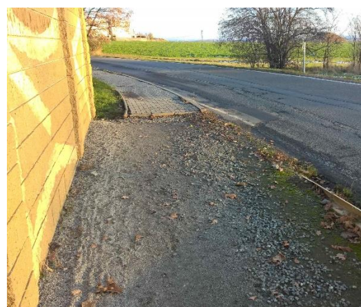
Obrázek 37 – Konec chybějící chodníkové plochy
