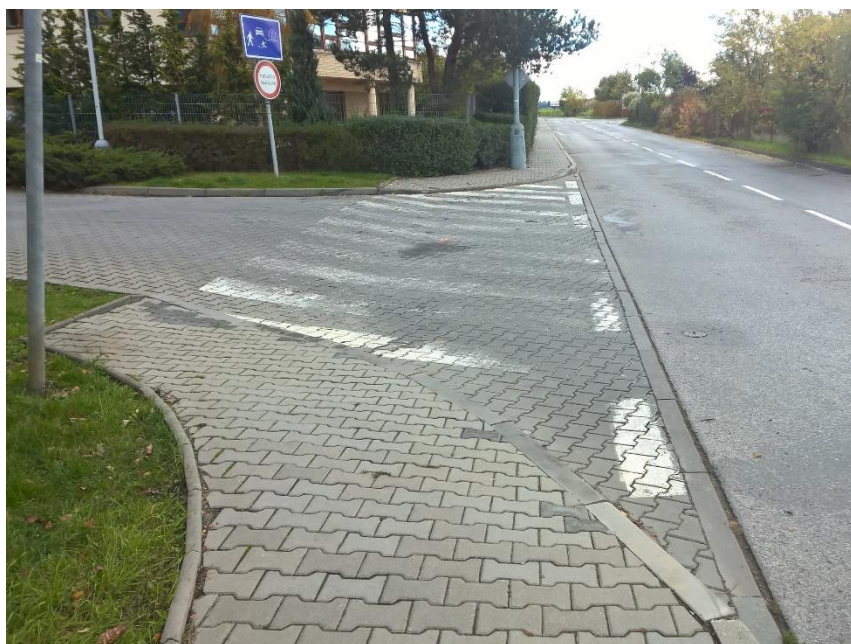
Obrázek 30 – Neodsazený přechod pro chodce
