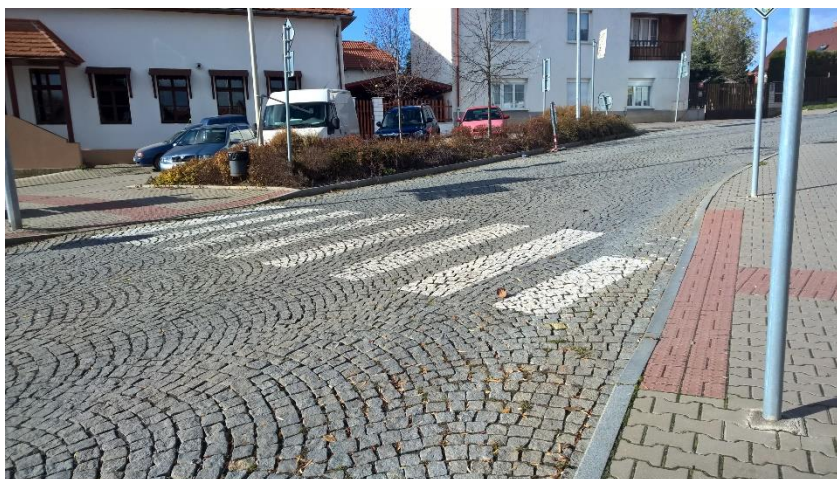
Obrázek 60 – Špatně provedený přechod pro chodce
