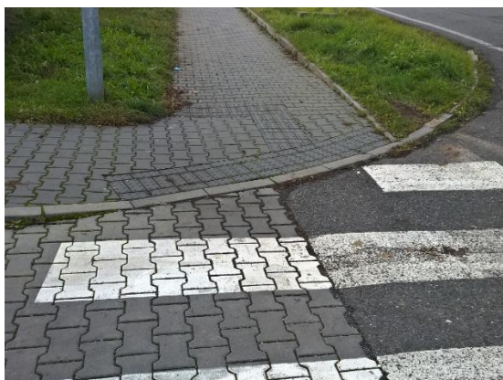
Obrázek 44 – Špatně řešený přechod pro chodce
