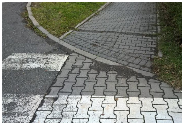
Obrázek 45 – Špatně řešený přechod pro chodce
