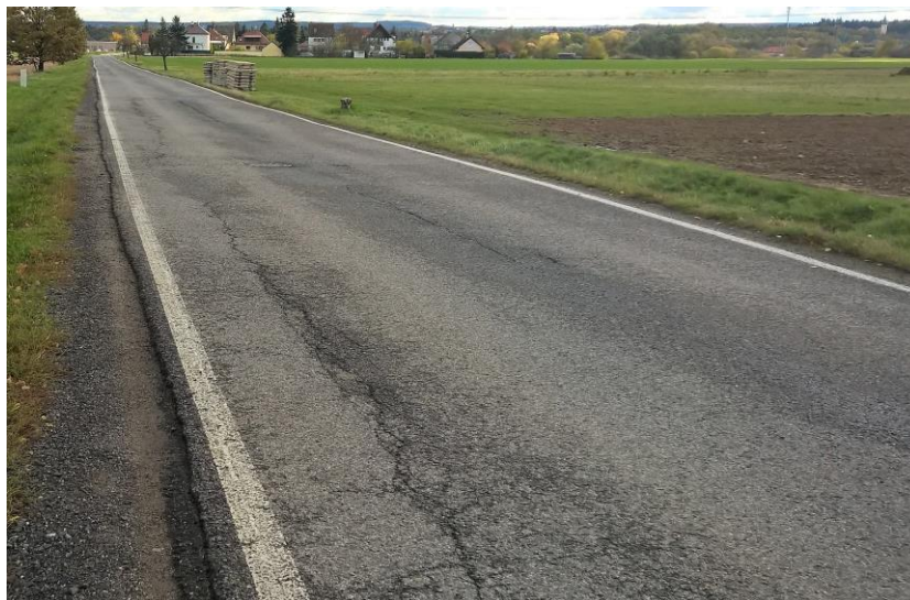
Obrázek 53 – Zvlněný a popraskaný povrch vozovky
