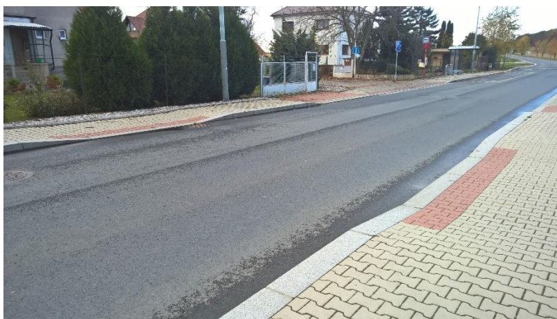
Obrázek 58 – Chybějící přechod pro chodce u školky
