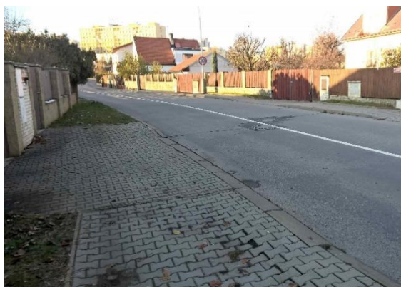
Obrázek 19 – Chybějící přechod pro chodce
